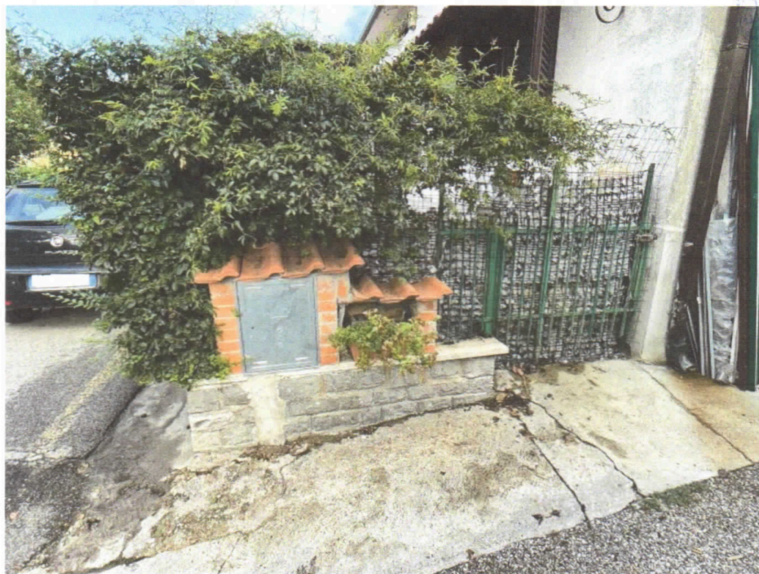
43) C.F. Fg.68 p.la 453 sub.4 – Impianto di riscaldamento particolare dell'ubicazione del contatore del metano
