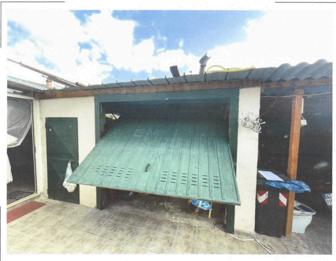
60) C.F. Fg.68 p.IIa 453 sub.3 – Particolare della legnaia con accessori due ripostigli attualmente in corso di trasformazione
