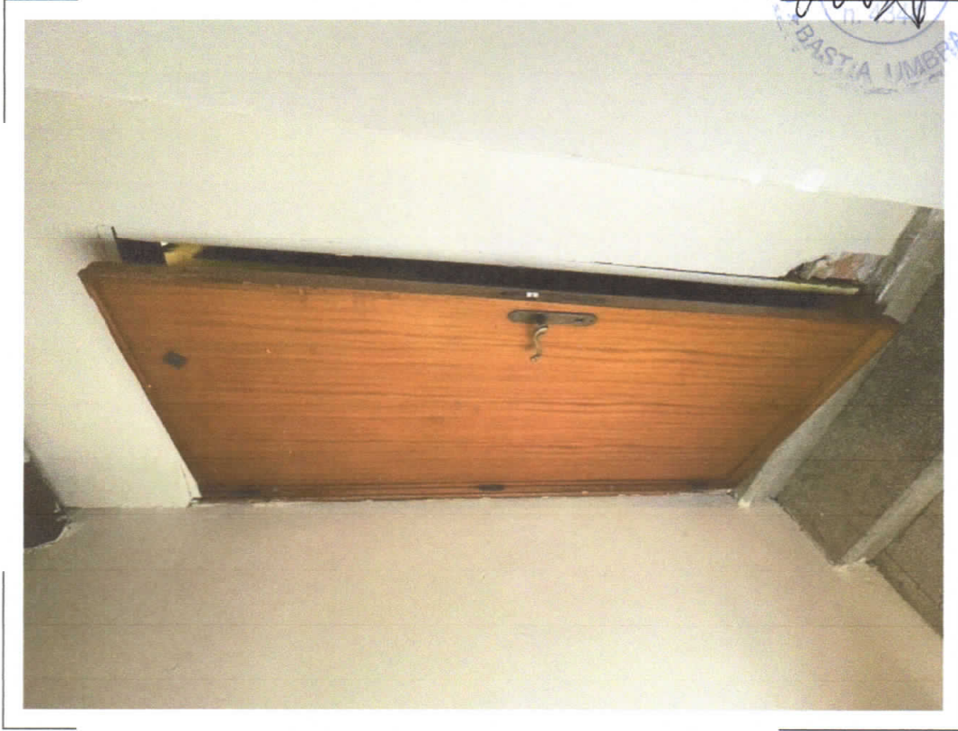
31) C.F. Fg.68 p.IIIa 453 sub.4 – Particolare degli infissi interni dei locali ubicati al piano primo/sottotetto
