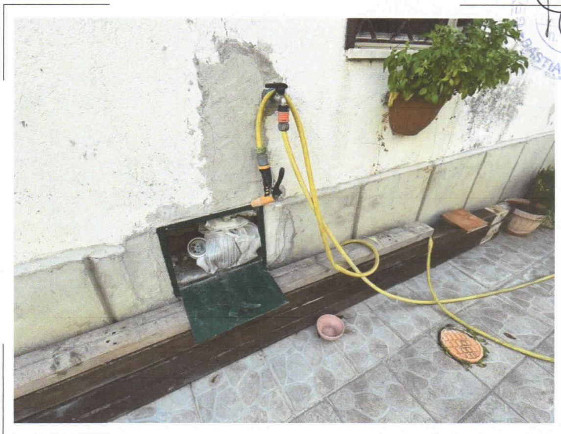
46) C.F. Fg.68 p.IIa 453 sub.4 – Particolare dell'ubicazione del contatore dell'acqua
