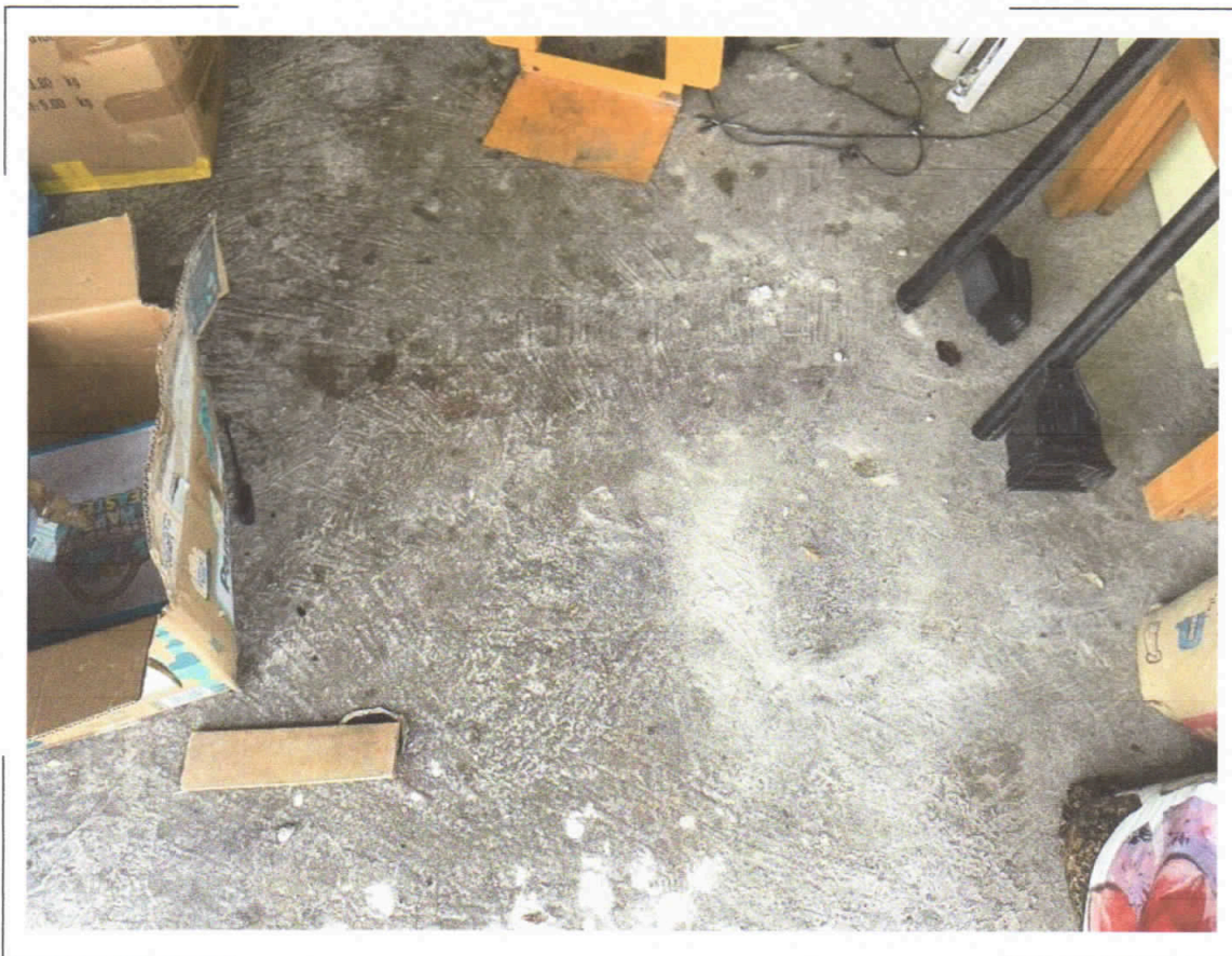
62) C.F. Fg.68 p.IIa 453 sub.3 – Particolare della pavimentazione della legnaia con accessori due ripostigli attualmente in corso di trasformazione
