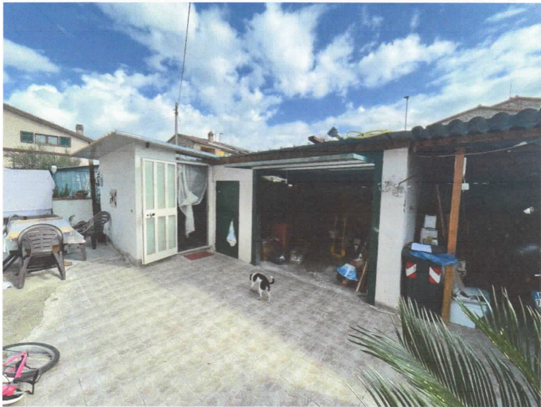
54) C.F. Fg.68 p.IIa 453 sub.3 – Vista generale della porzione di fabbricato oggetto di stima adibita a legnaia con accessori due ripostigli
