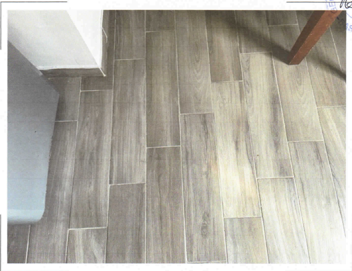
57) C.F. Fg.68 p.IIa 453 sub.3 – Particolare della pavimentazione della legnaia con accessori due ripostigli trasformata a cucina rustica
