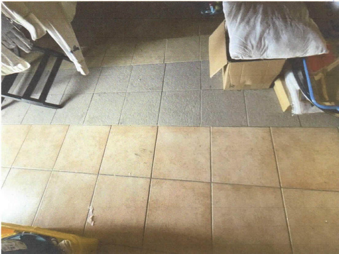
24) C.F. Fg.68 p.IIa 453 sub.4 – Particolare della pavimentazione della soffitta al piano primo/sottotetto adibita a lavanderia
