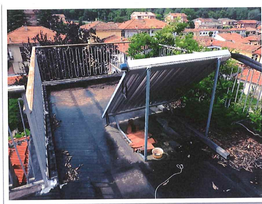
Foto N. 60: vista del lastrico solare e dei pannelli solari della villa;
