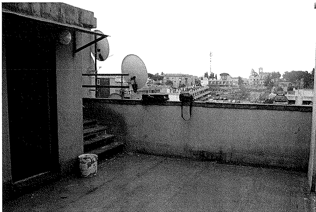
LAVATOIO VIA MAZZEO DI RICCO 4- TERRAZZO - FOGLIO 294 PARTICELLA 235 SUB 504-EDIFICIO 6
