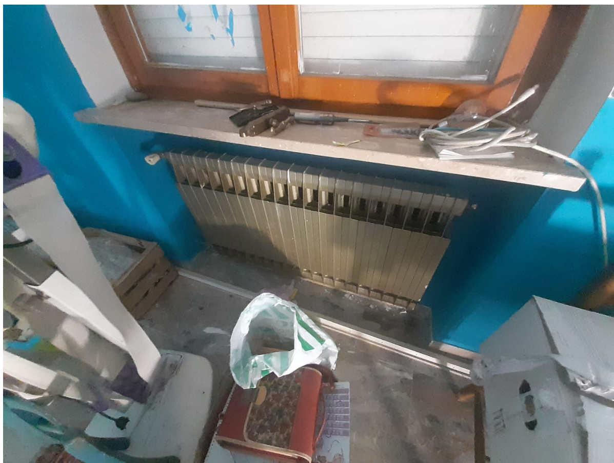
Vista particolare termosifoni a servizio dei locali
