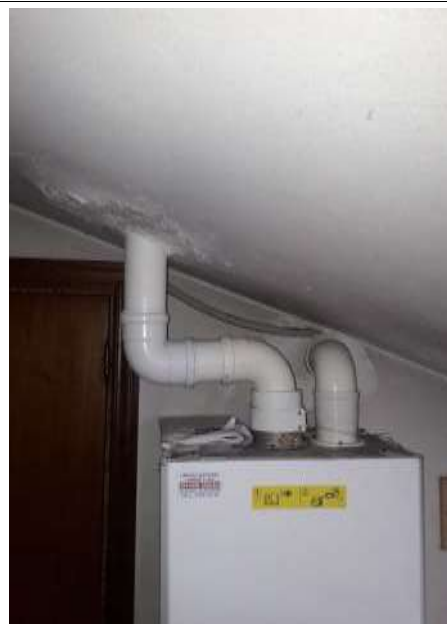
Caldaia gas metano condivisa sub 15-14
