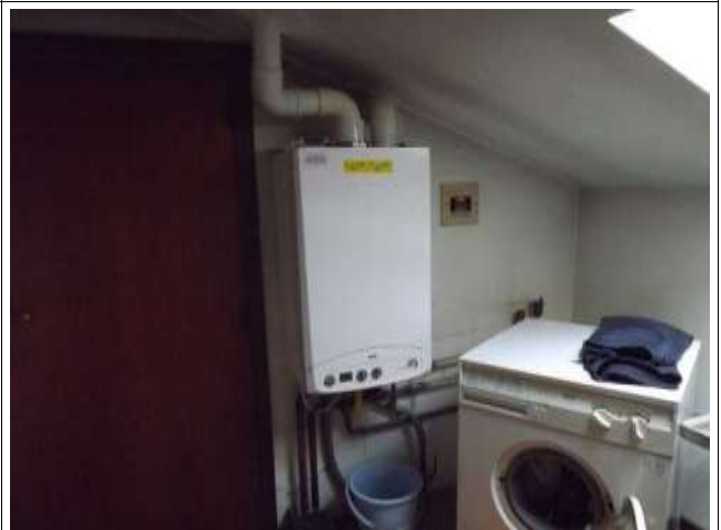
Locale caldaia sottotetto bene comune sub 14-15
