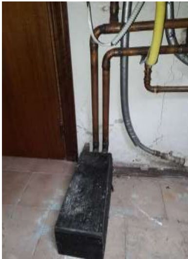
Part. Locale caldaia sottotetto- adduzione la collettore appartamento p1
