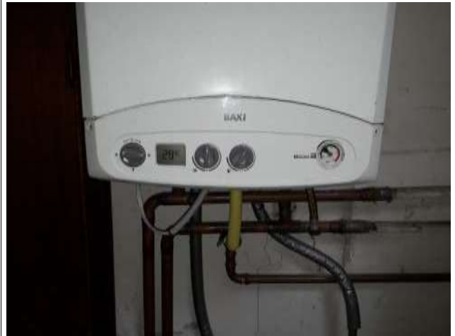
Caldaia piano sottotetto condivisa sub 15-14
