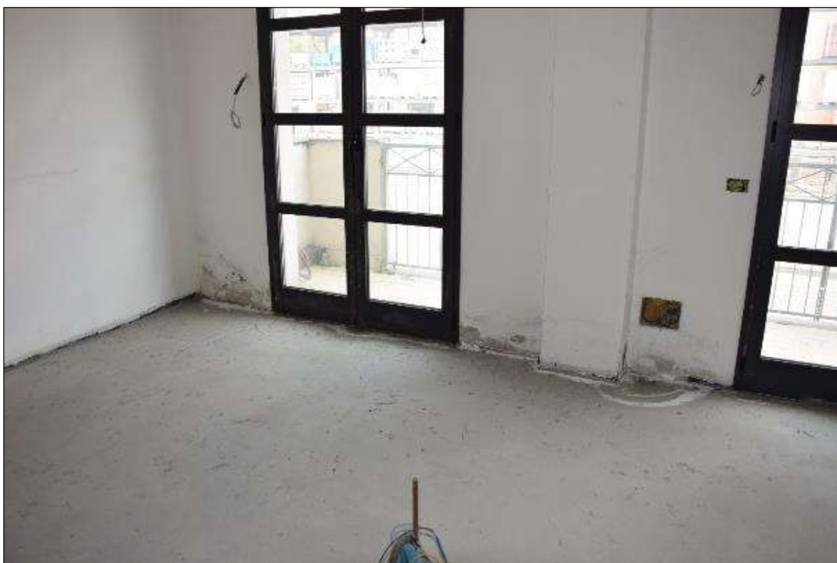
FOTO 66 – particolare - infiltrazioni d'acqua dalla terrazza
