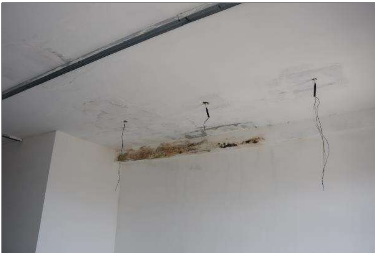
FOTO 25 – particolare - infiltrazioni d’acqua dal piano sottotetto
