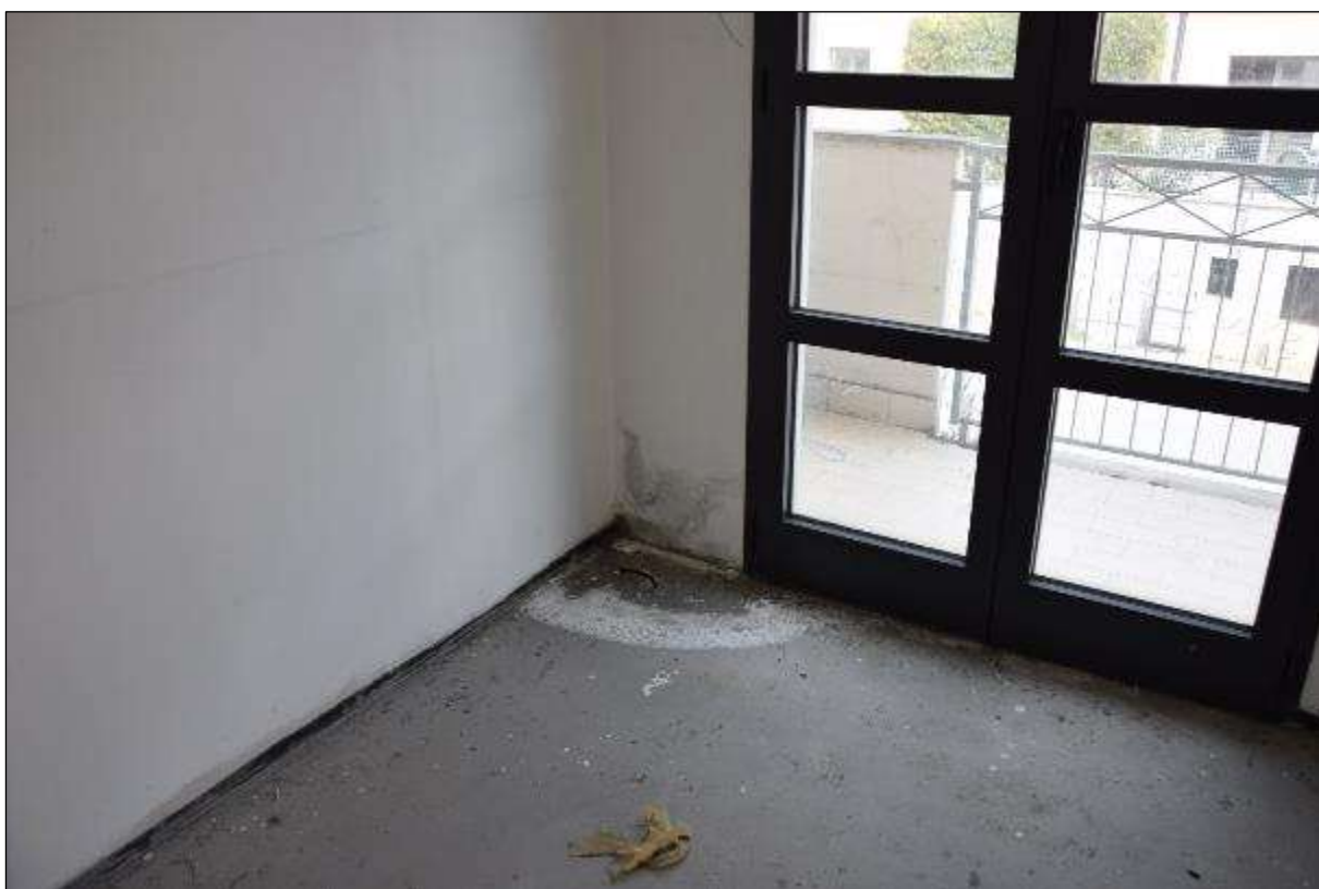
FOTO 107 – particolare - infiltrazioni d'acqua dalla terrazza
