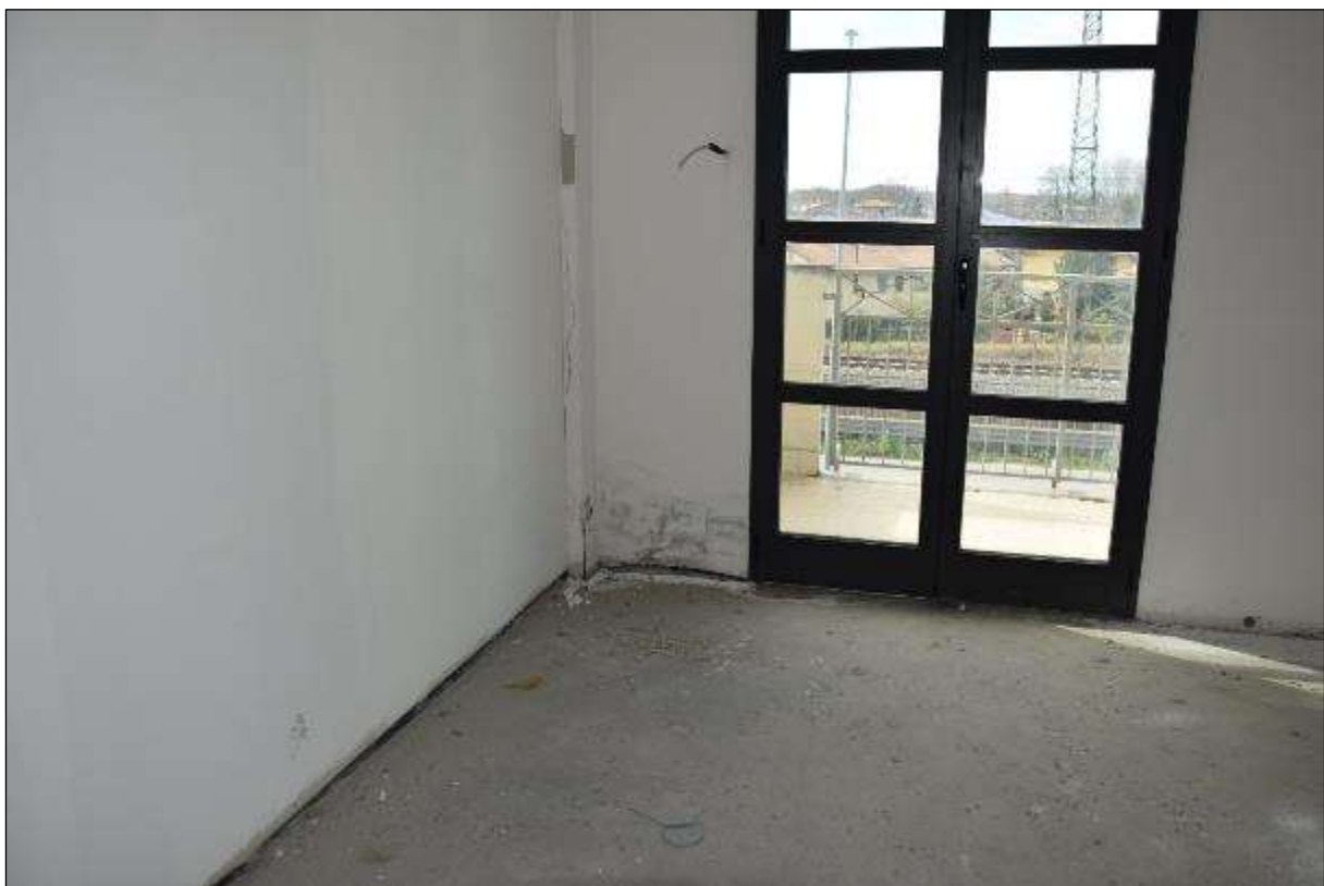
FOTO 31 – particolare - infiltrazioni d'acqua dalla terrazza
