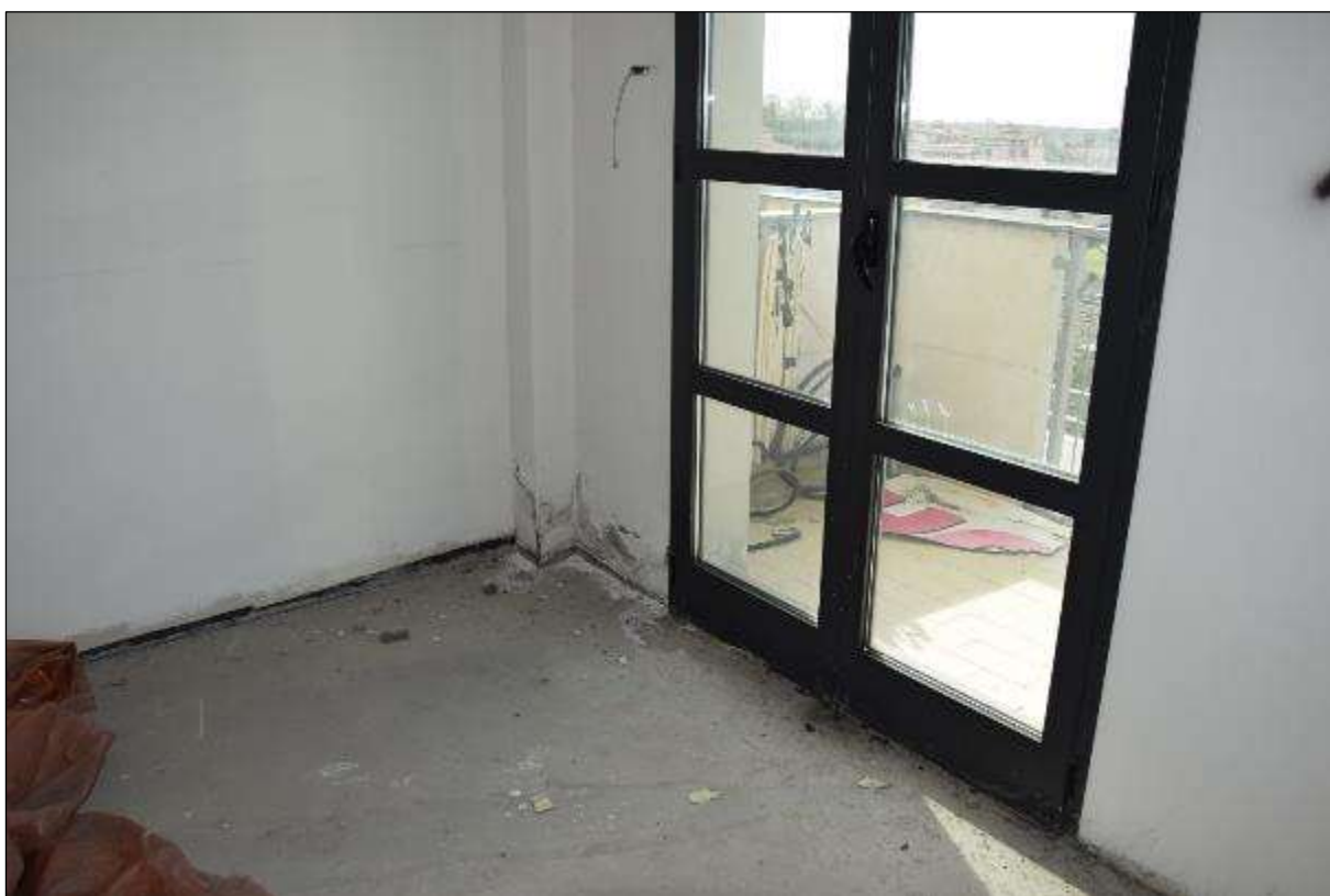
FOTO 44 – particolare - infiltrazioni d'acqua dalla terrazza
