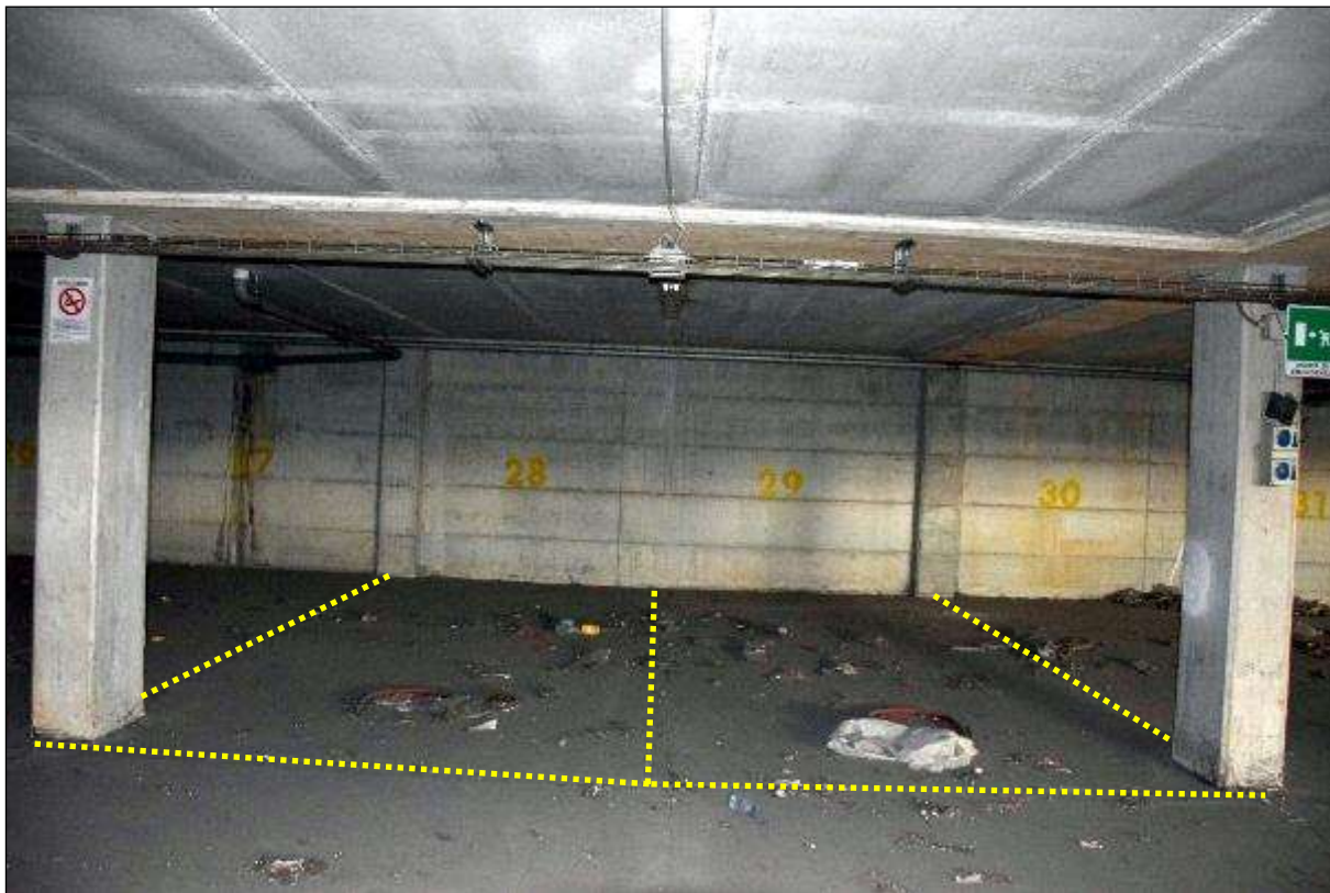
FOTO 7 – SUB 49 (POSTO 28) / SUB 50 (POSTO 29)
