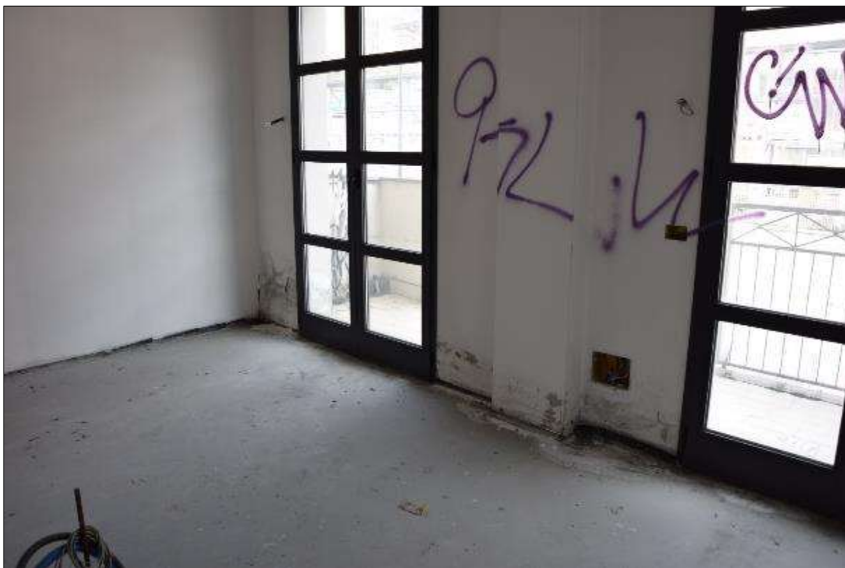
FOTO 78 – particolare - infiltrazioni d'acqua dalla terrazza
