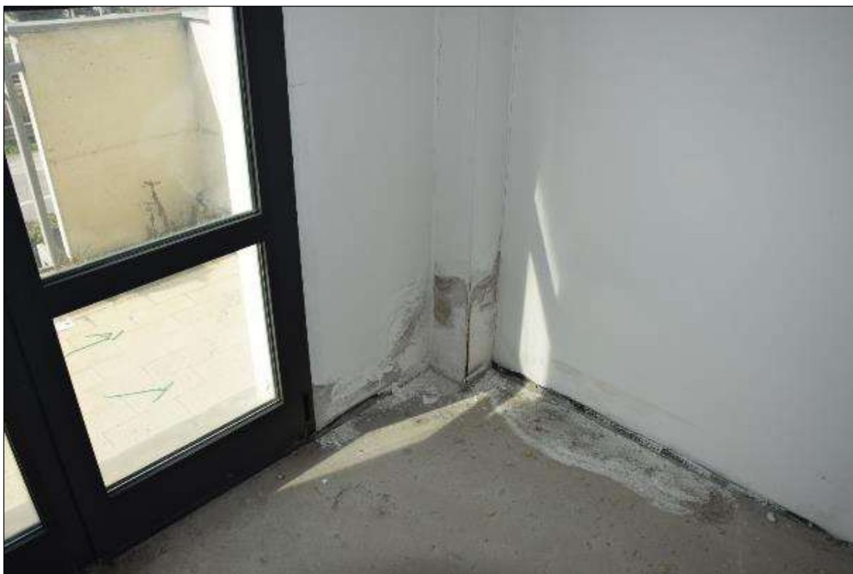
FOTO 12 – particolare - infiltrazioni d'acqua dalla terrazza
