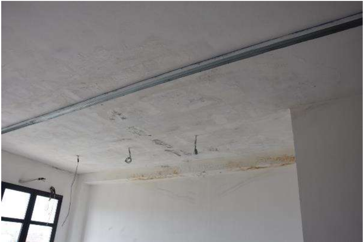
FOTO 32 – particolare - infiltrazioni d'acqua dal piano sottotetto
