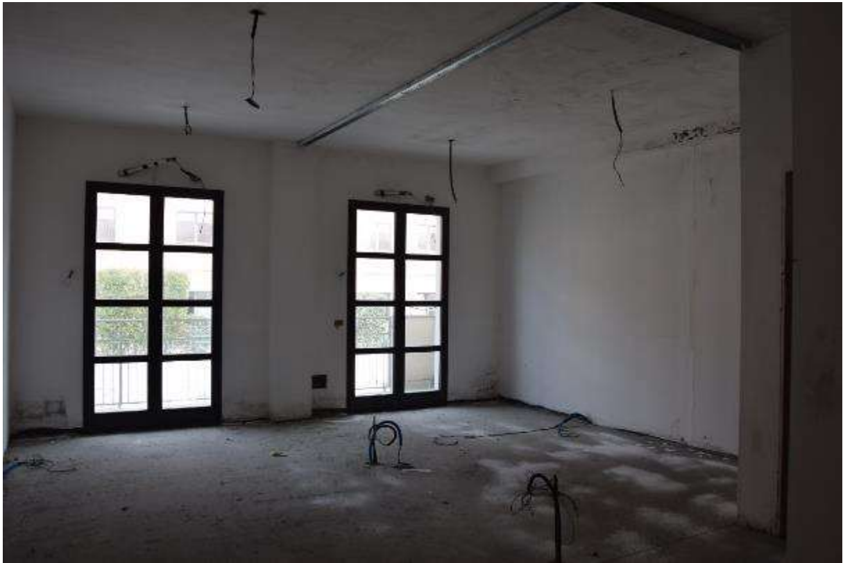
FOTO 98 – particolare - infiltrazioni d’acqua dal piano sottotetto
