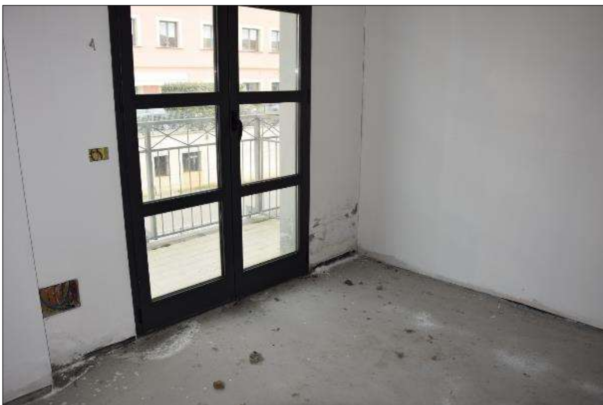
FOTO 90 – particolare - infiltrazioni d'acqua dalla terrazza
