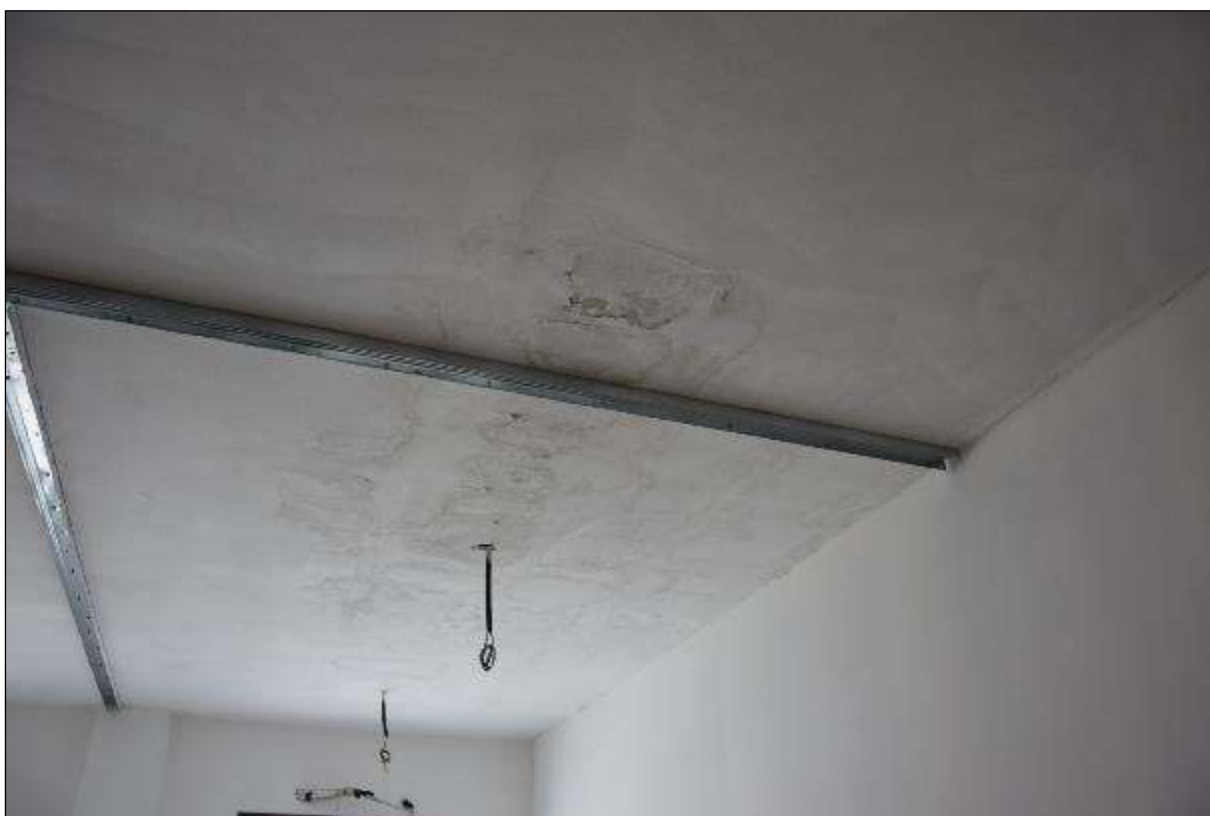
FOTO 91 – particolare - infiltrazioni d’acqua dal piano sottotetto
