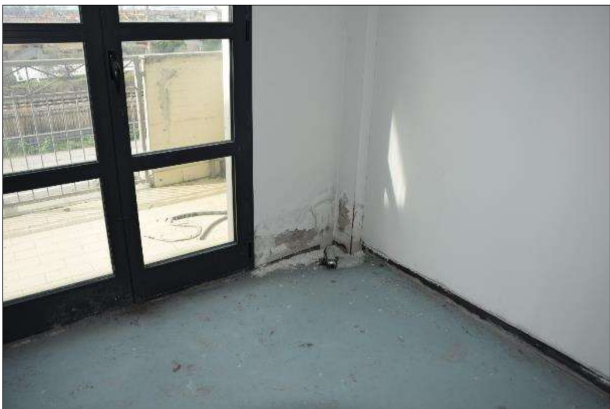
FOTO 24 – particolare - infiltrazioni d'acqua dalla terrazza
