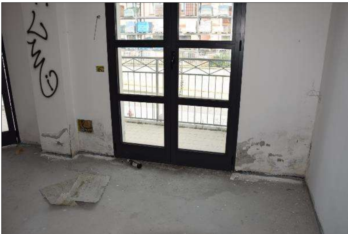
FOTO 72 – particolare - infiltrazioni d'acqua dalla terrazza
