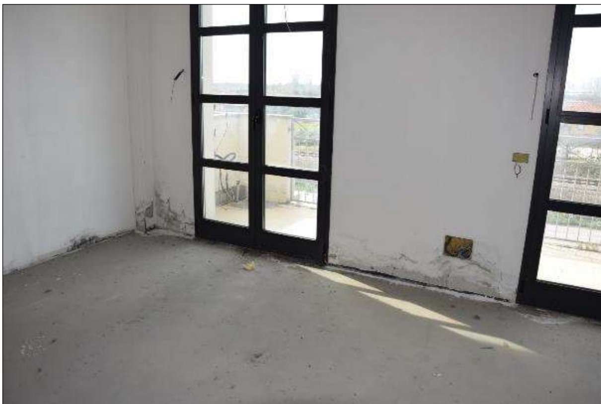
FOTO 18 – particolare - infiltrazioni d'acqua dalla terrazza
