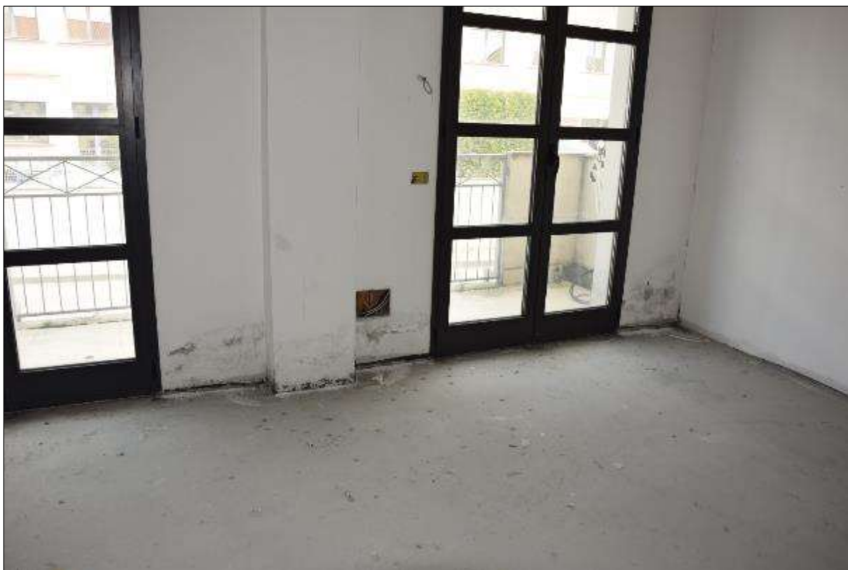
FOTO 84 – particolare - infiltrazioni d'acqua dalla terrazza
