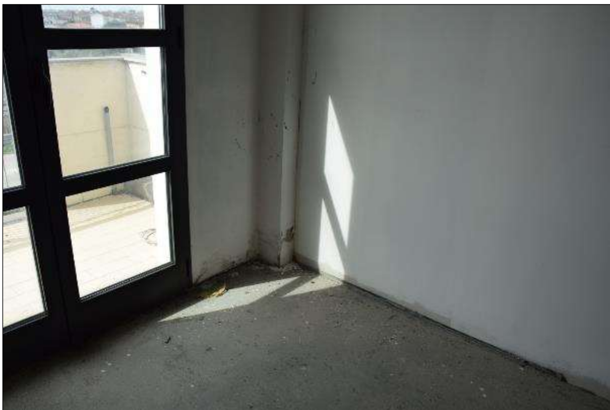
FOTO 38 – particolare - infiltrazioni d'acqua dalla terrazza
