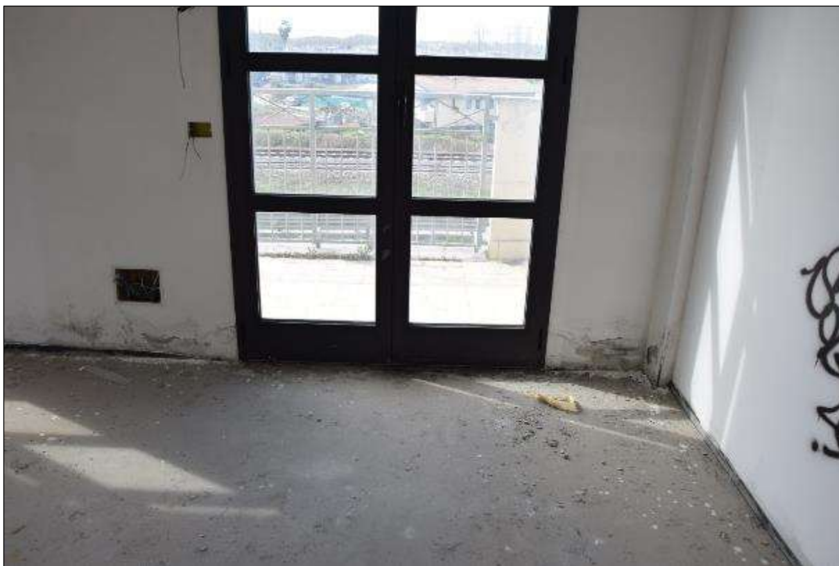
FOTO 49 – particolare - infiltrazioni d'acqua dalla terrazza
