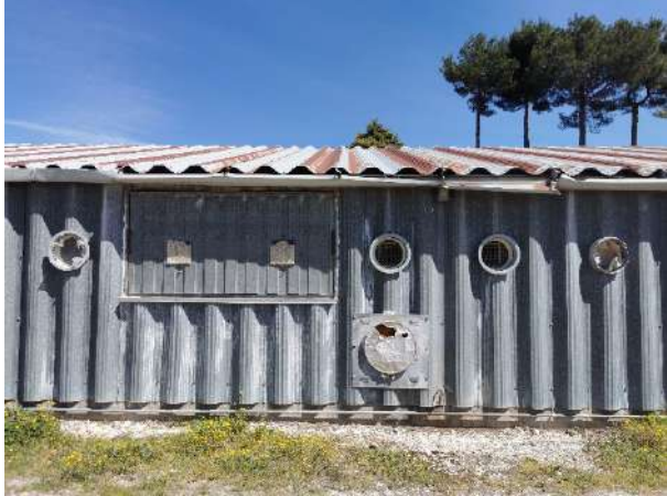
Foto dettaglio degrado n° 4
