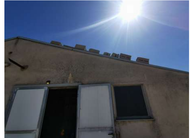
Foto dettaglio degrado n° 6
