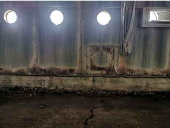
Foto dettaglio degrado n° 3
