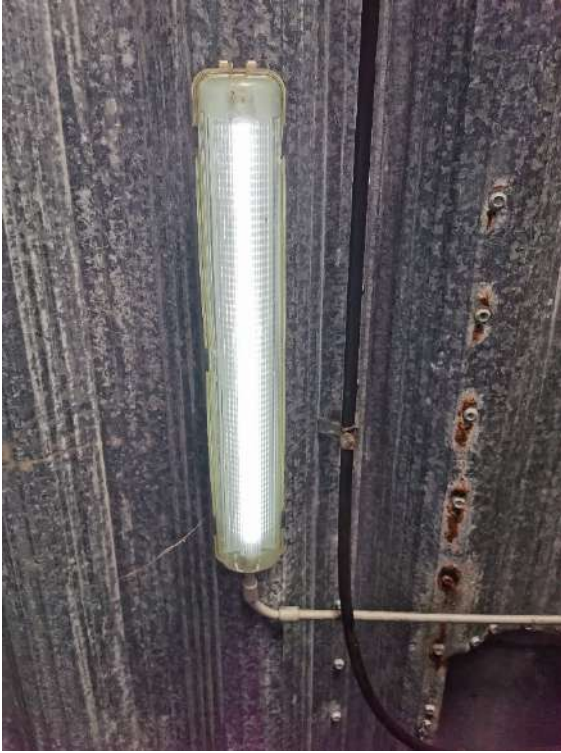
Foto dettaglio degrado n° 7
