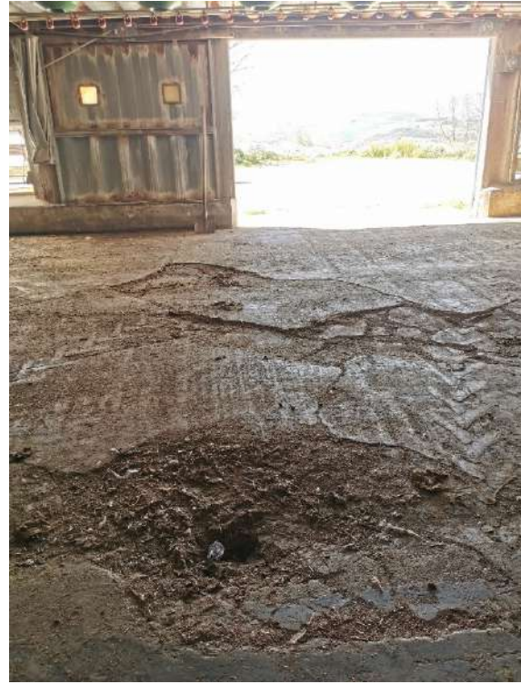
Foto dettaglio degrado n° 8
