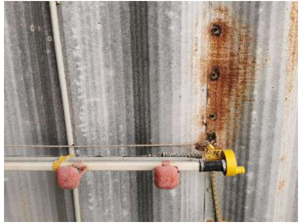
Foto dettaglio degrado n° 2
