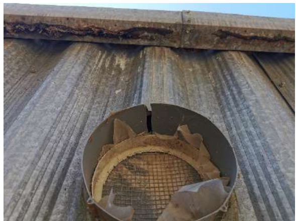
Foto dettaglio degrado n° 5
