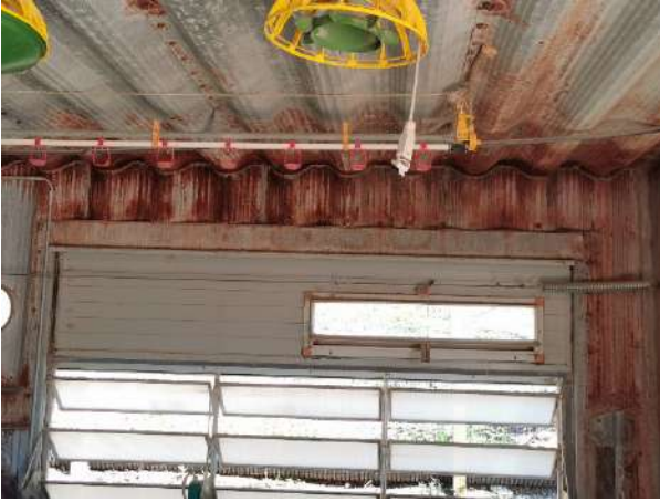
Foto dettaglio degrado n° 1
