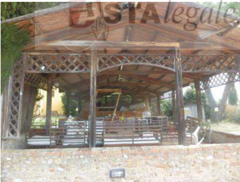
STATO AMMALORATO TETTOIA A SERVIZIO PISCINA A COMUNE BENI 8 E 9
