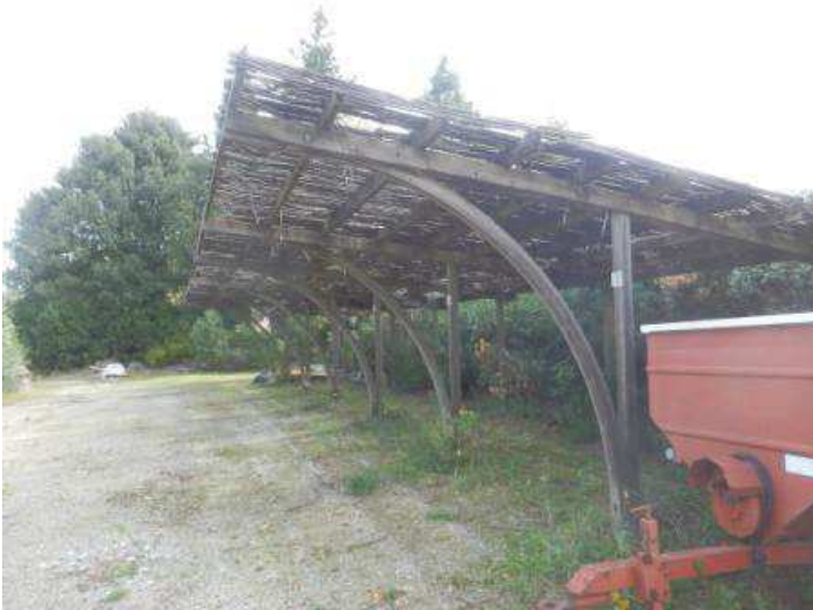
STATO PRECARIO DELLE TETTOIE BENE 8 E 9
