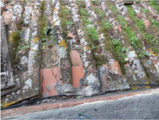
BENE 1 particolare del tetto ammalorato
