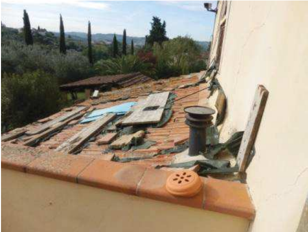
BENE 4 TETTO PERICOLANTE
