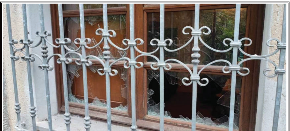
Foto n. 15 – Finestra al piano terra danneggiata da atti vandalici
