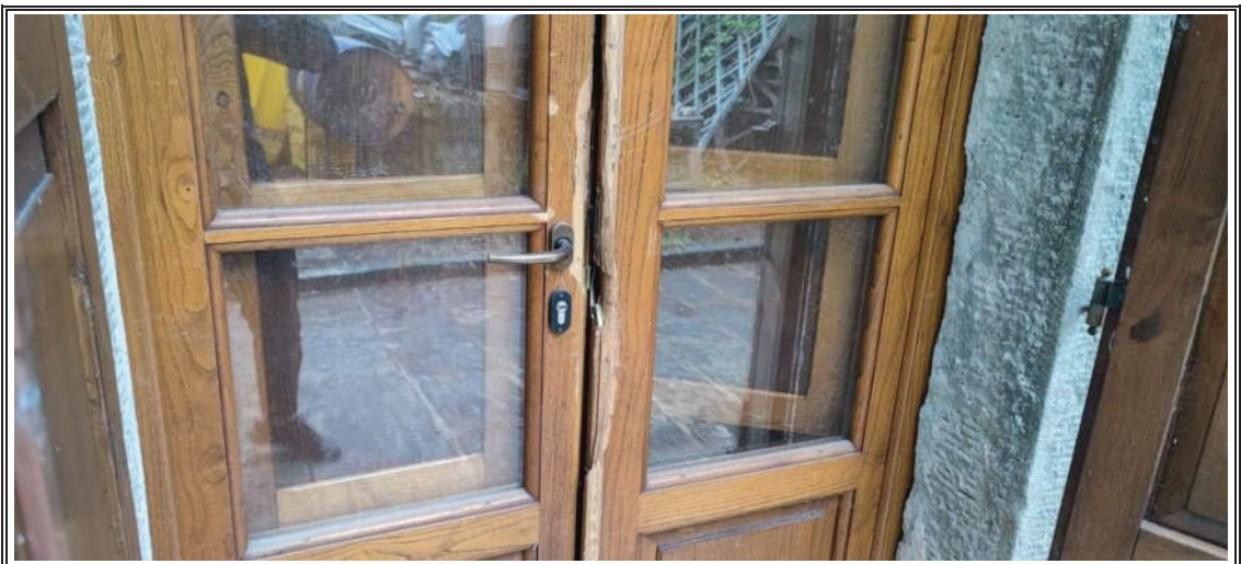
Foto n. 14 – Porta di ingresso danneggiata da atti vandalici
