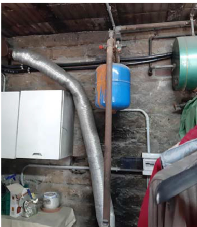
Foto n.18: La condotta di esalazione fumi comune.
