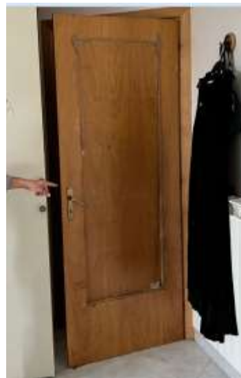
Fenomeni di umidità per condensazione
