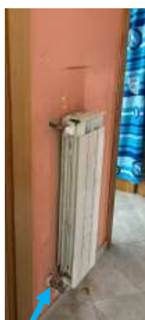
Impianto riscaldamento caldaia murale + termosifoni in alluminio
