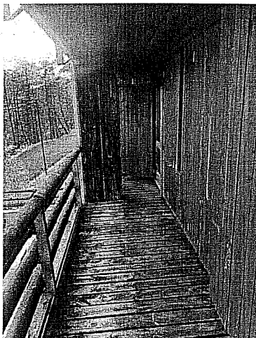
FOTO 7 – RIPRESA FOTOGRAFICA EFFETTUATA DAL C.T.U. - balcone
