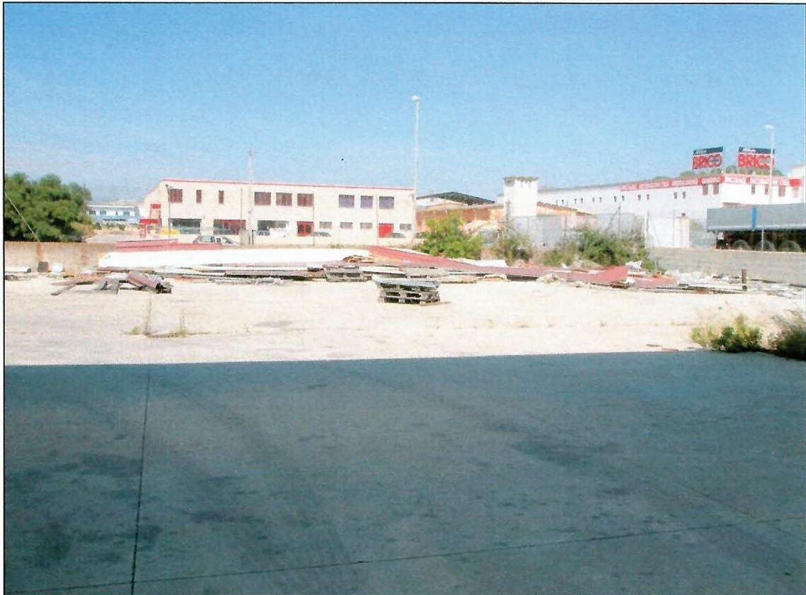
Foto n° 19 – Pannelli di rivestimento del capannone rovinati dal vento.
