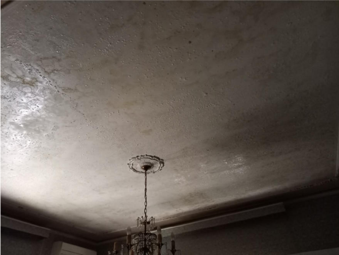
Foto 9 – infiltrazioni di acqua sul soffitto del piano primo
