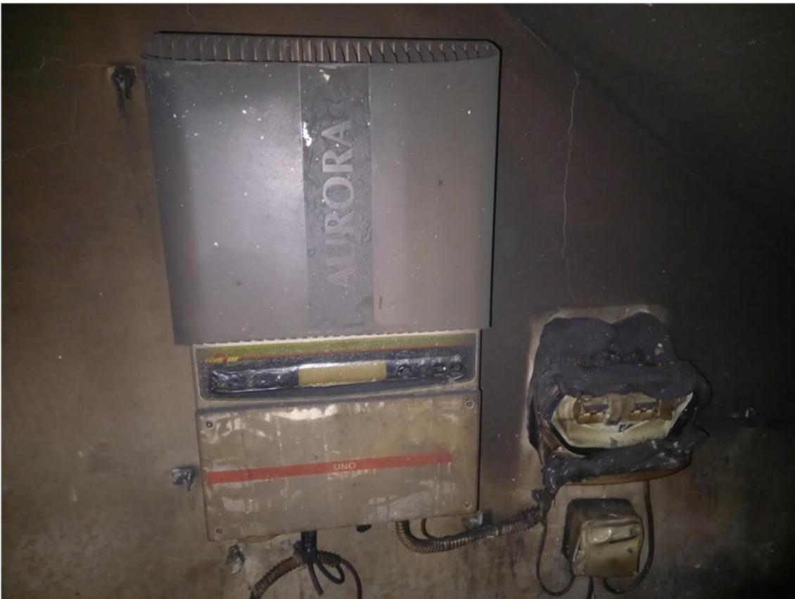
Foto 8 – particolare inverter e quadro impianto fotovoltaico bruciati
