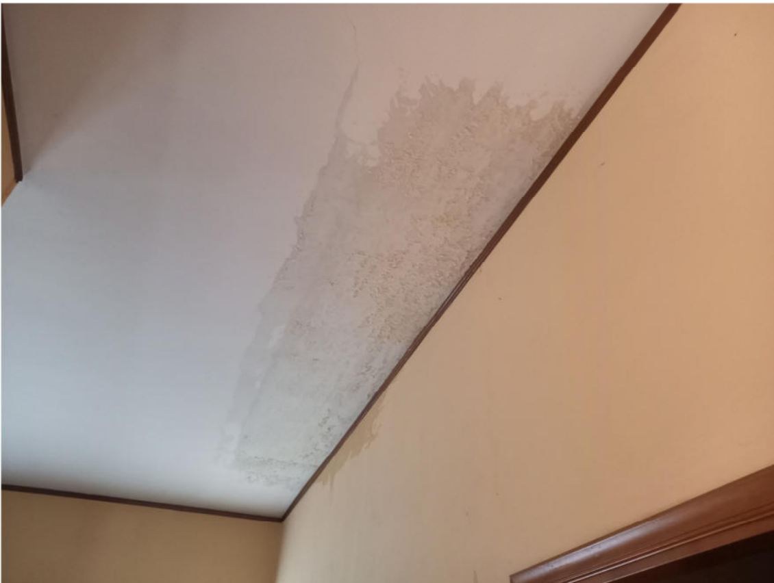
Foto 10 – infiltrazioni di acqua sul soffitto del piano primo
