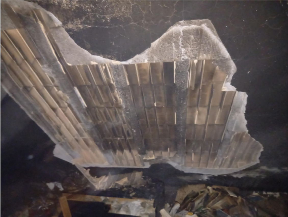
Foto 5 – particolare prima porzione solaio copertura sfondellato
