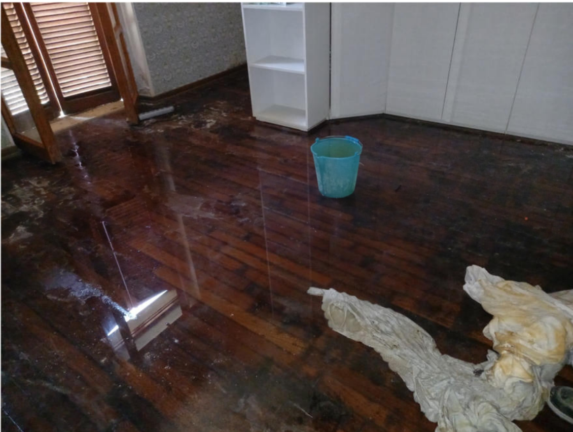
Foto 12 – danneggiamento pavimento al piano primo
