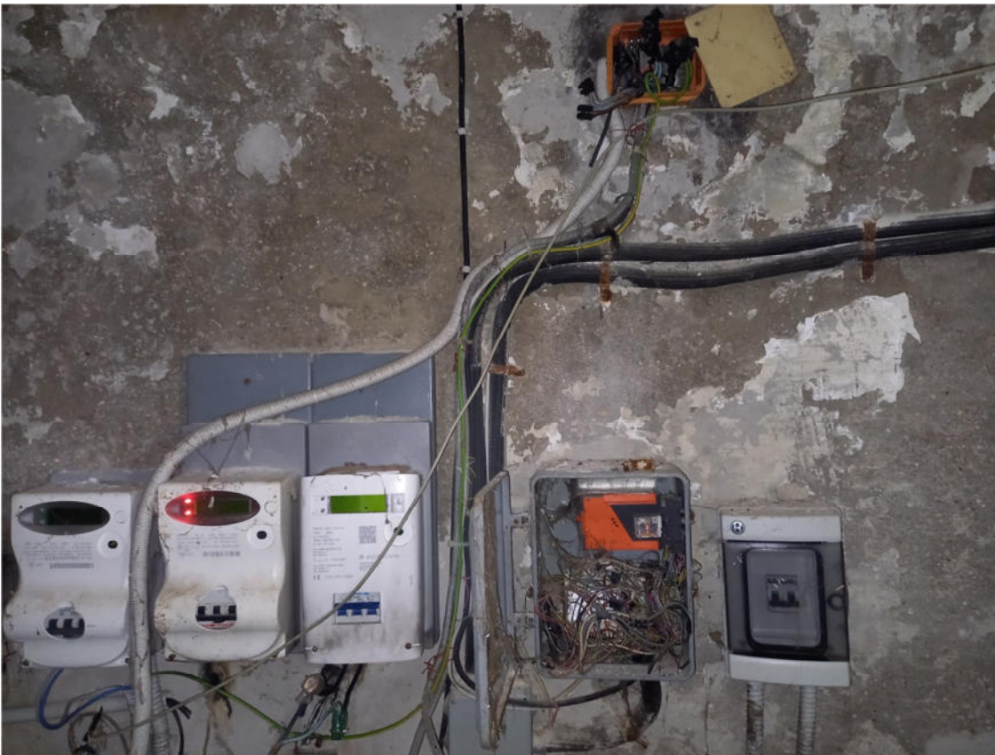
Foto 2 – vano contatori – si noti l’assenza di protezioni magnetotermiche e differenziali
