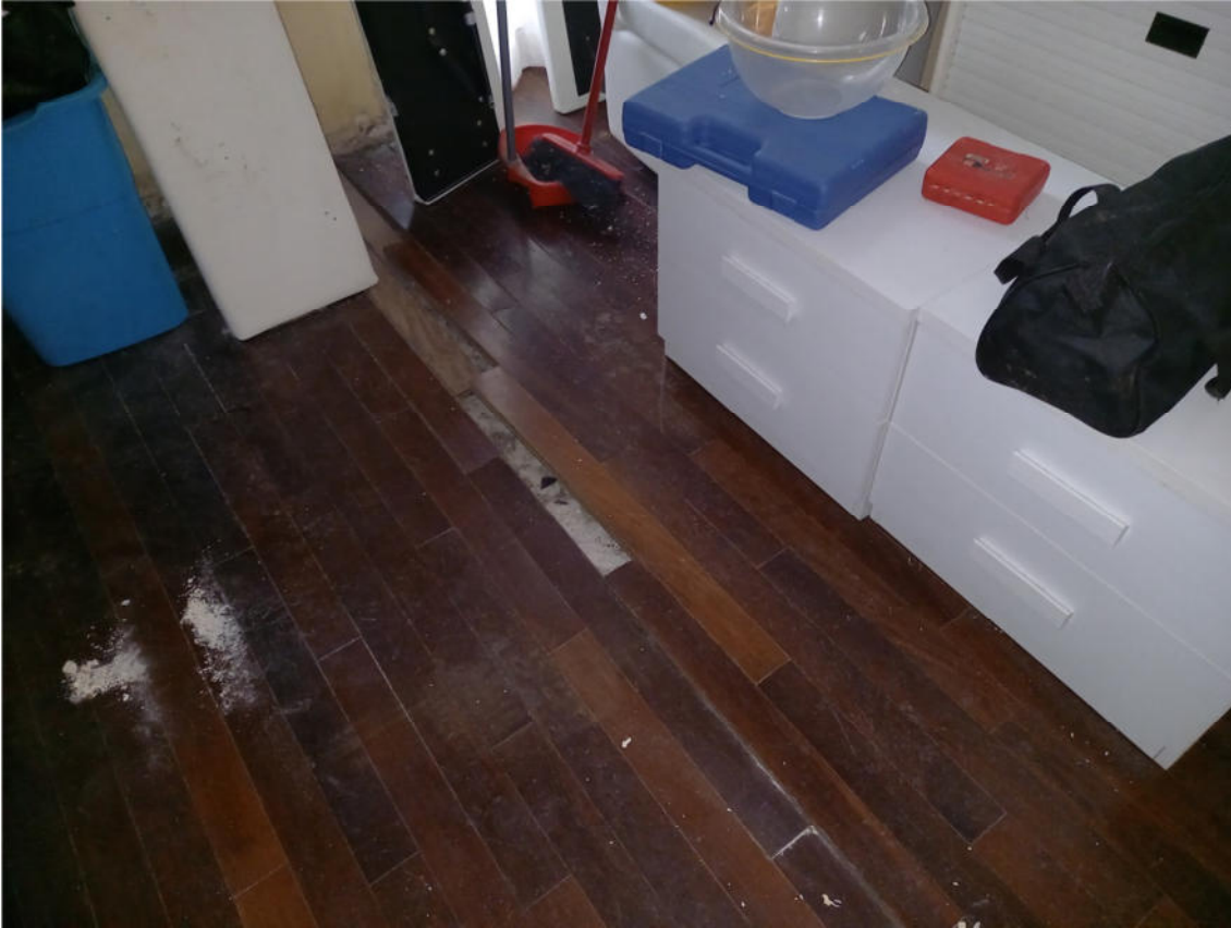
Foto 11 – danneggiamento pavimento al piano primo
