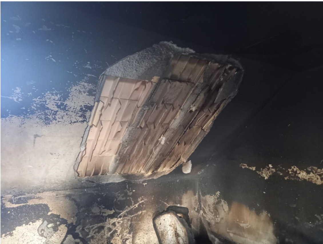
Foto 6 – particolare seconda porzione solaio copertura sfondellato
