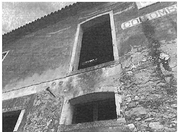
foto n. 66 – particolare fascia copertura fienile priva di coppi
