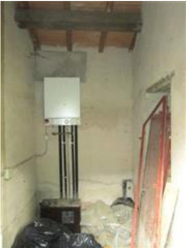
Locale caldaia al P.T.
