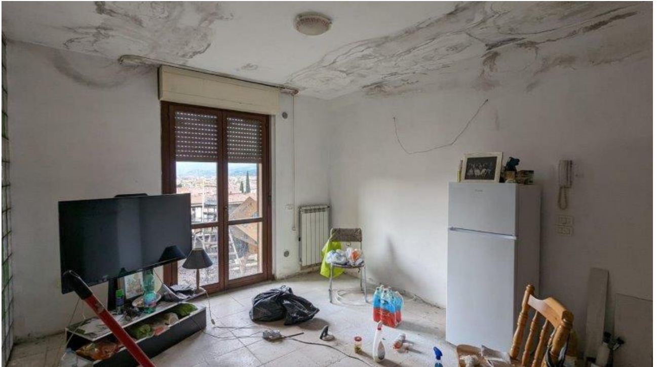
Foto n.6 – Soggiorno – soffitto ammalorato
