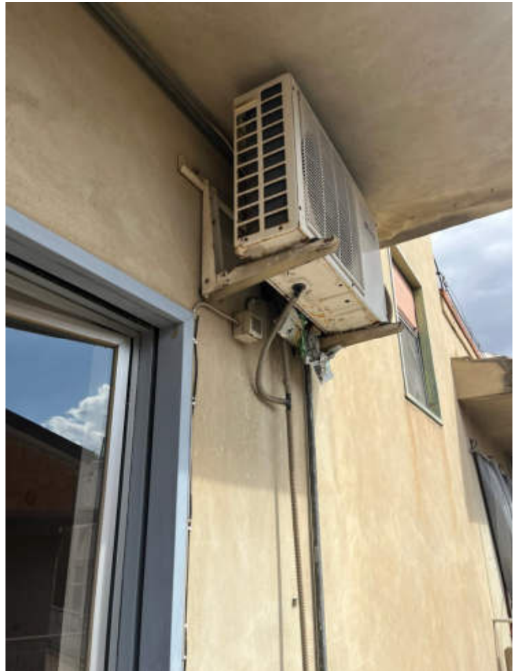
Unità esterna condizionatore non funzionante
