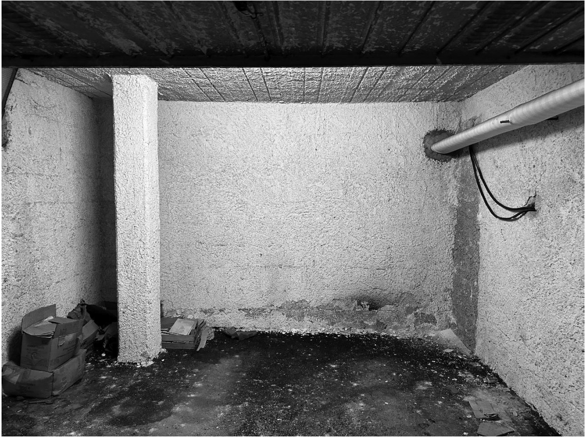
FOTO 9. DETTAGLIO INTERNO BOX.
