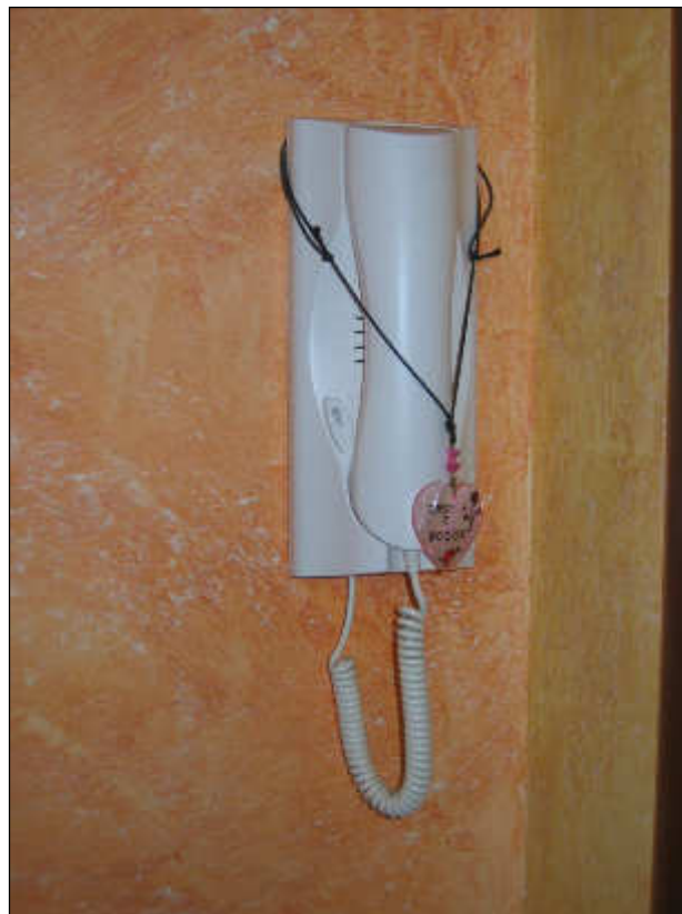
Foto n° 24 – Vista del citofono.
