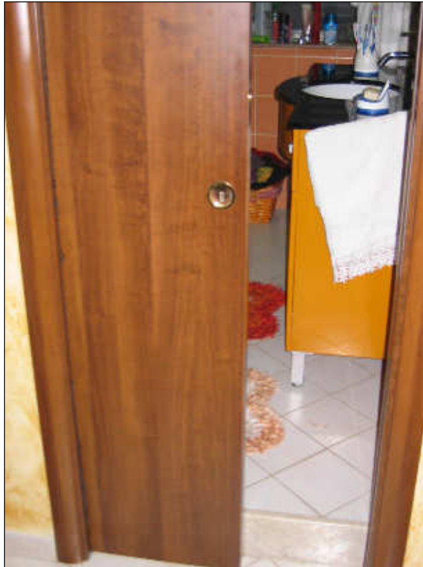
Foto n° 35 – Foto scattata alla porta a scomparsa che consente l'ingresso nel bagno. Ottimo lo stato di finitura.
