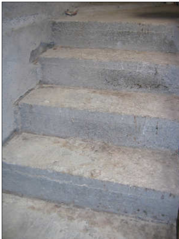
Foto n° 14 – Altra foto scattata alla rampa di accesso ai piani superiori. La scala risulta priva di ogni rifinitura, sia nelle pareti che nei gradini.
