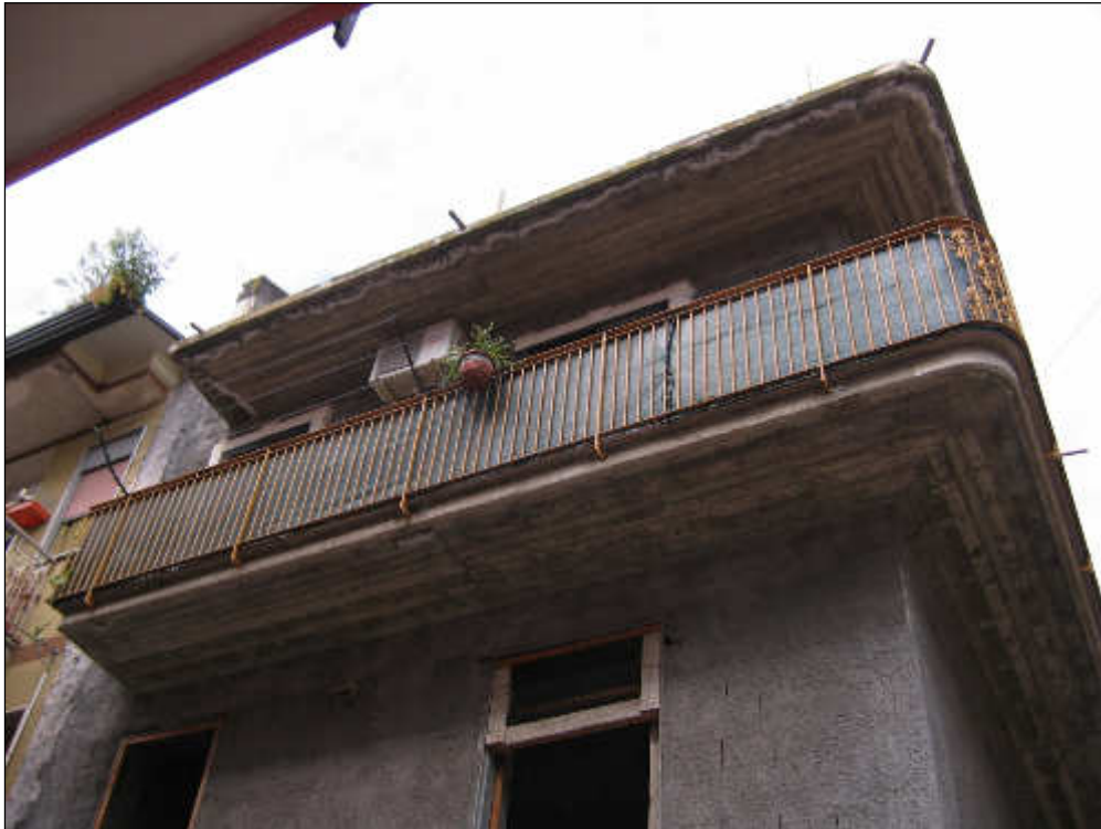
Foto n° 5 – Altra vista dell'edificio situato in via Toselli a Scordia. Il primo piano è allo stato rustico, ossia è privo di intonaco, di finiture, di infissi e di ringhiere nel ballatoio.
