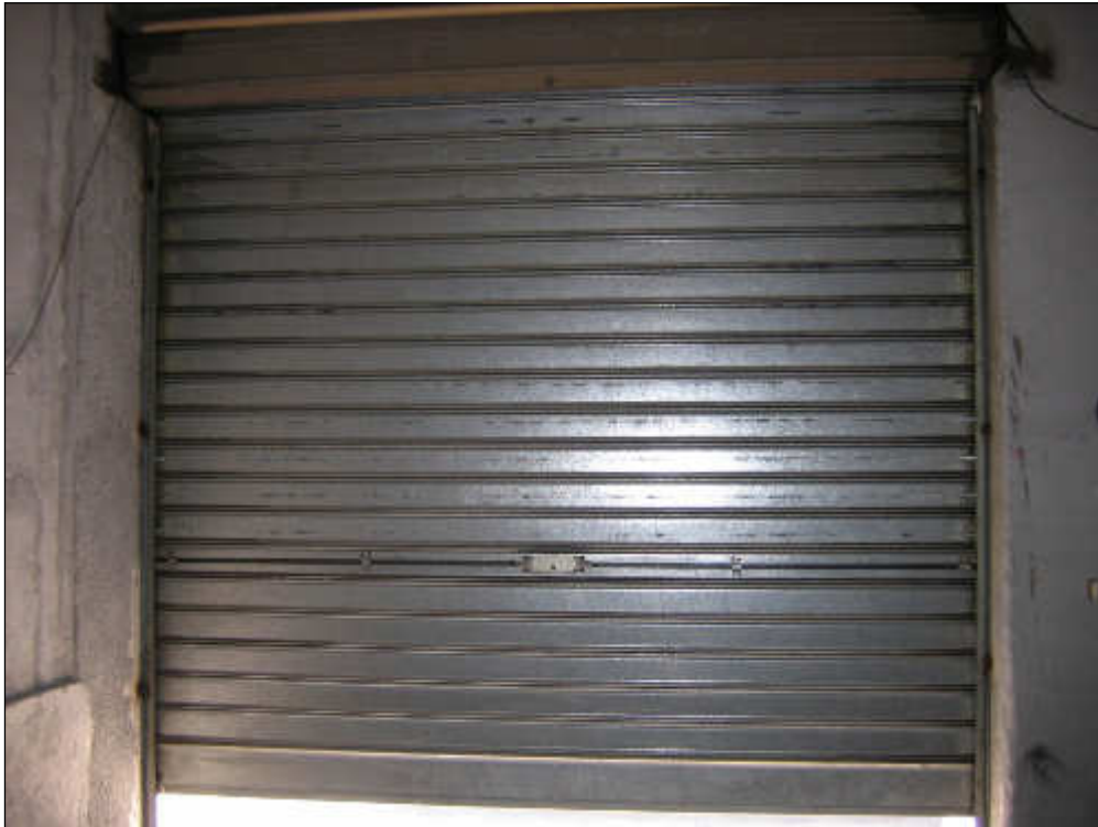
Foto n° 7 – Foto scattata dall'interno del garage. Le pareti sono solo intonacate ma non rifinite.
