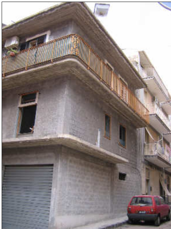
Foto n° 2 – Altra vista dell'edificio situato in via Toselli angolo via Dabormida a Scordia. I prospetti sono tutti allo stato rustico, ossia privi di intonaco e di finiture.
