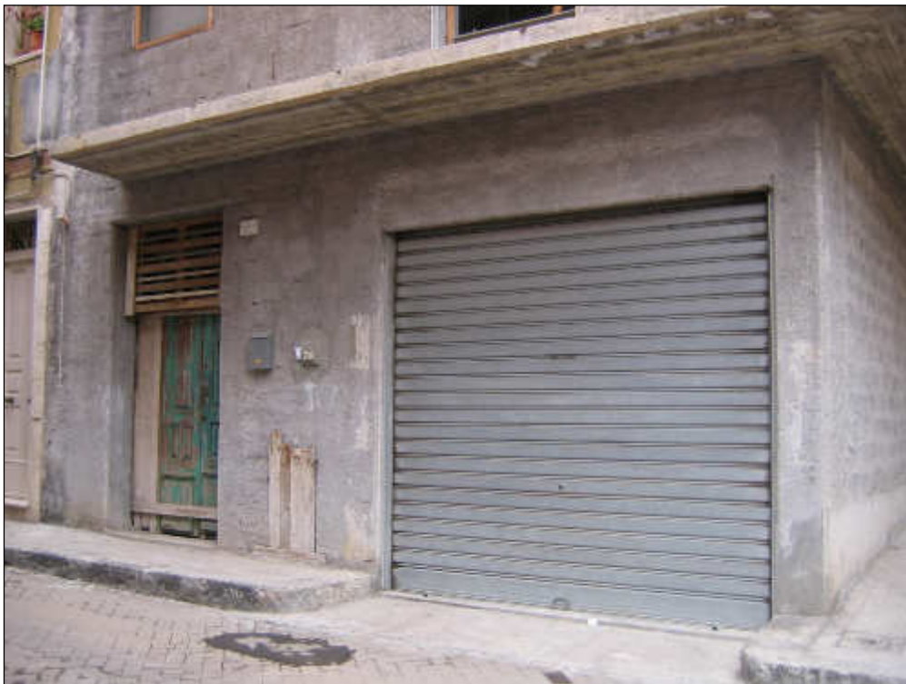
Foto n° 6 – Altra foto scattata nel prospetto di via Toselli a Scordia. Il piano terra è allo stato rustico; è solo presente un portoncino in legno in precarie condizioni. L'ingresso al garage avviene dalla saracinesca ubicata in via Toselli. Dal garage si accede anche alla scala che conduce ai piani superiori.
