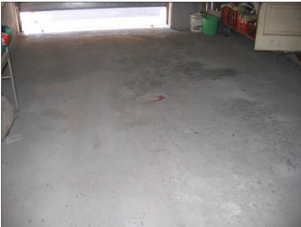
Foto n° 8 – Altra foto scattata dall'interno del garage. Il piano di calpestio è privo di pavimento.
