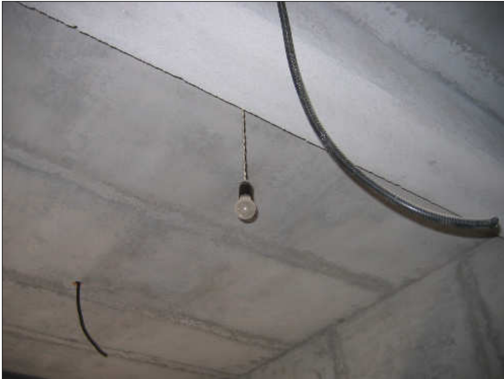
Foto n° 9 – Foto scattata all'interno del garage. Il soffitto è intonacato ma è privo dello strato di finitura. L'impianto elettrico è fuori traccia e/o fatiscente.
