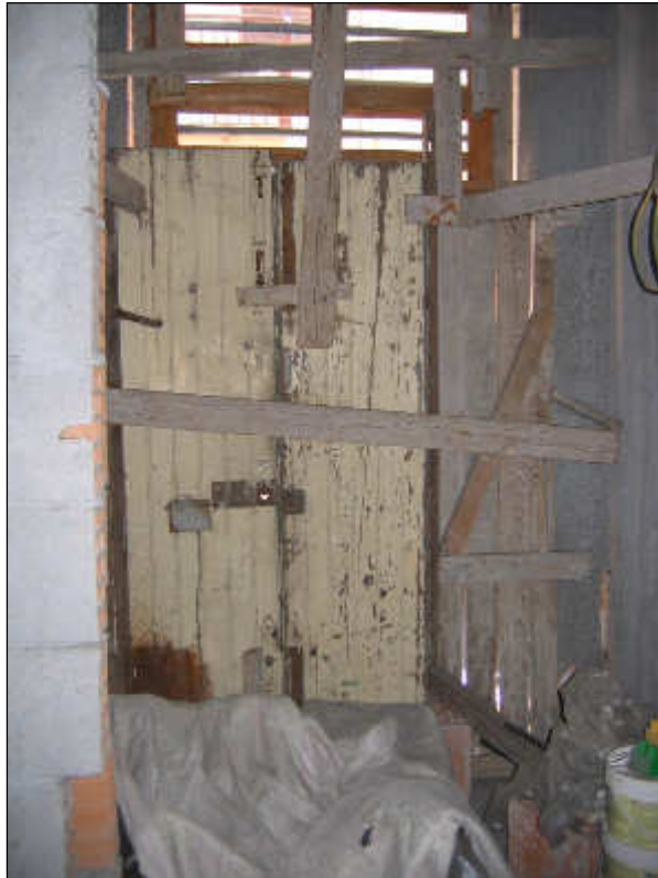
Foto n° 11 – Foto scattata dall'interno del vano scala al portoncino di ingresso. Lo stesso riversa in precarie condizioni.
