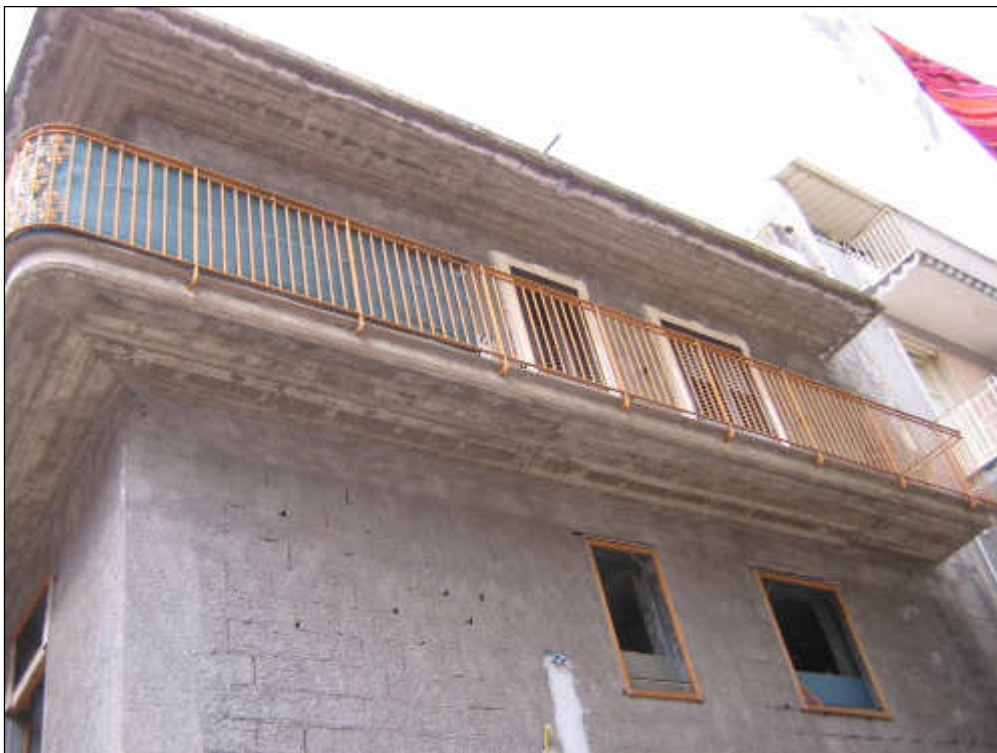
Foto n° 4 – Altra vista dell'edificio situato in via Dabormida a Scordia. Il secondo piano è privo di intonaco e di finiture.
