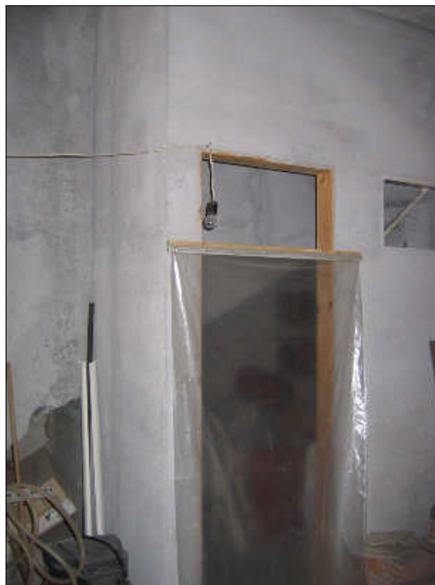
Foto n° 10 – Foto scattata al ripostiglio che è stato ricavato nel sottoscala. Le pareti sono intonacate ma sono prive dello strato di finitura. L'impianto elettrico è fuori traccia e del tutto fatiscente.
