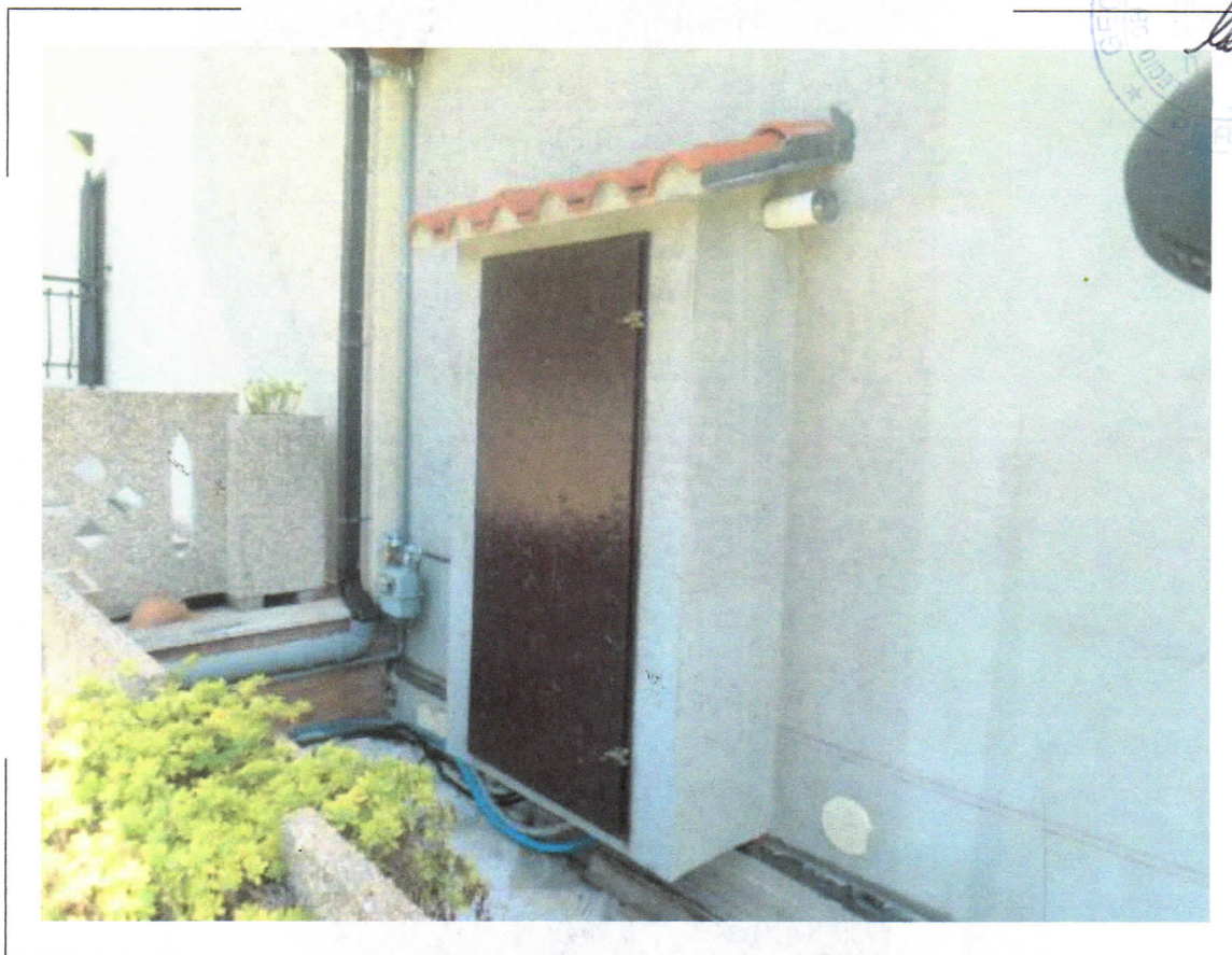
54) NCEU Fg.38 p.la 619 sub.5 (blocco 2 e 3) – Particolare dell'ubicazione della caldaia gas-gpl a servizio esclusivo della porzione ad uso abitazione
