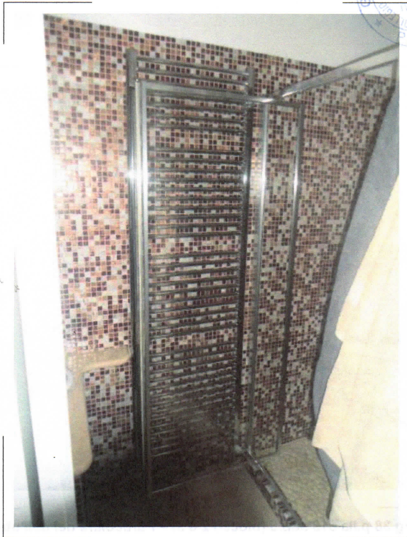
53) NCEU Fg.38 p.la 619 sub.5 (blocco 2) – Particolare del riscaldamento e degli elementi radianti
