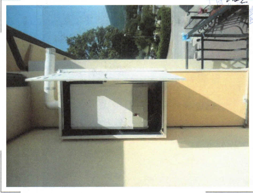
32) NCEU Fg. 38 p.IIa 619 sub.5 (blocco 1) – Particolare dell'ubicazione della caldaia a servizio esclusivo dell'appartamento al piano primo
