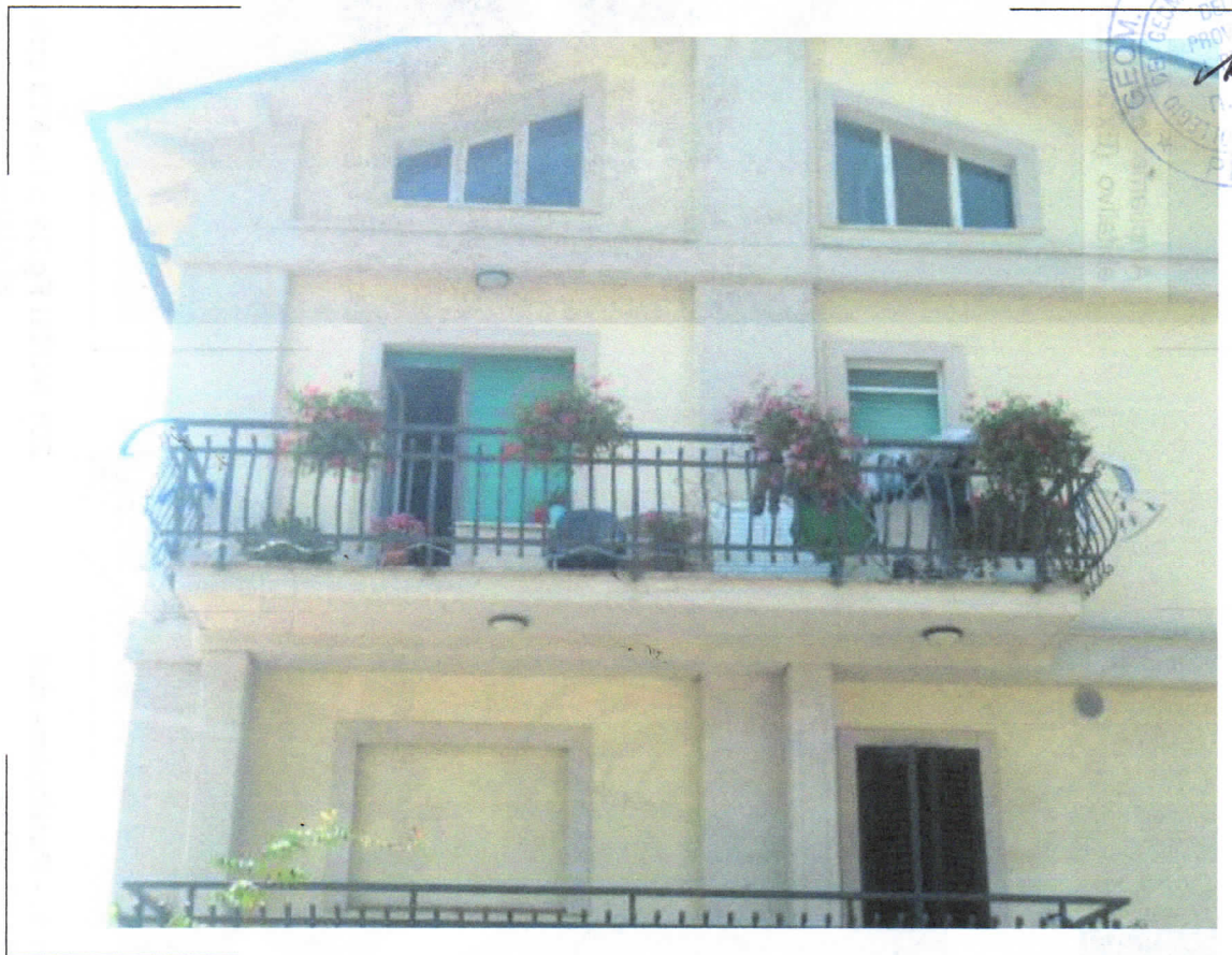
18) NCEU Fg.38 p.IIa 619 sub.5 (blocco 1) – Vista generale del terrazzo al piano primo oggetto di stima
