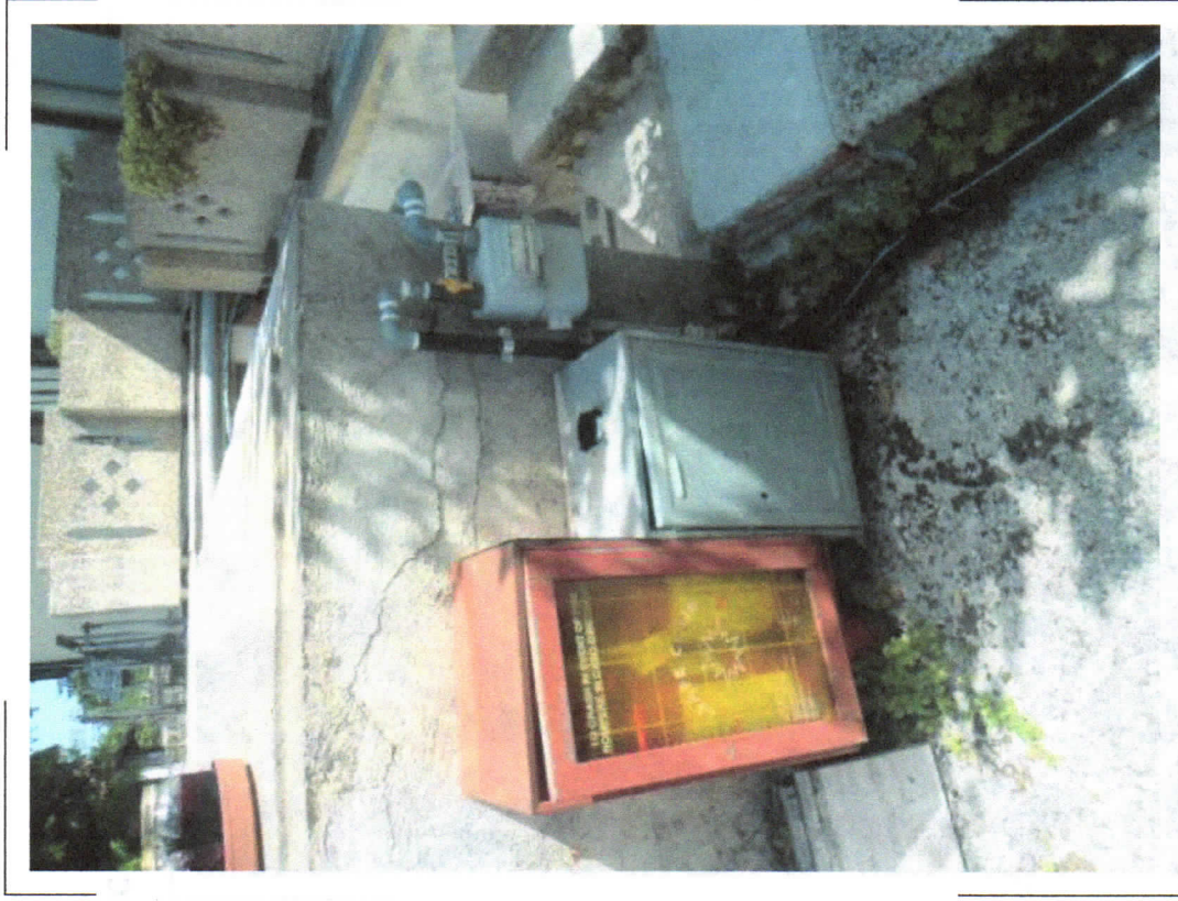
33) NCEU Fg.38 p.IIa 619 (blocco 1) – Corte esterna ad uso comune, particolare dell'ubicazione del contatore del gas-metano
