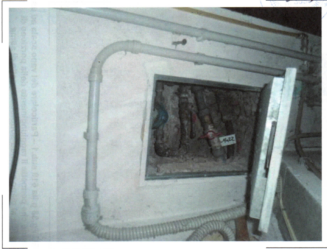
36) NCEU Fg.38 p.Illa 619 sub.5 – Particolare dell'ubicazione del contatore impianto idrico, locale deposito-sgombero piano primo sottostrada
