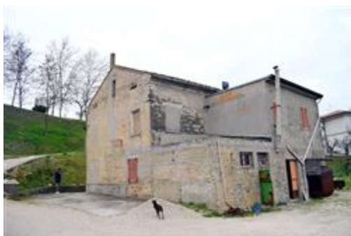
Vista del fabbricato di cui la porzione pignorata è parte, con terreni agricoli adiacenti o prossimi ad essa
