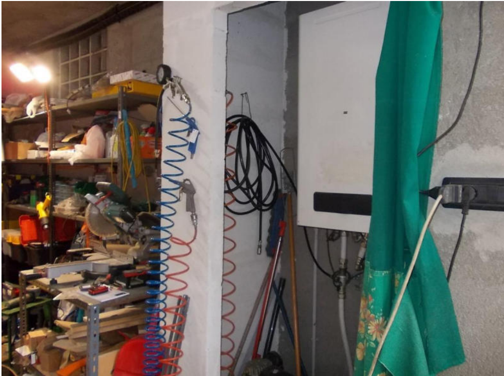
Foto 9 Locale caldaia da regolarizzare interno garage sub.2 p.t.
