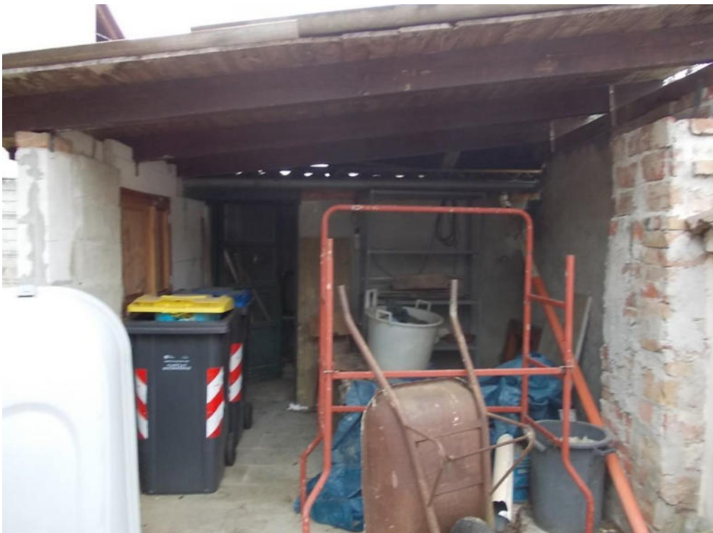
Foto 26 Portico aperto abusivo p.t.
