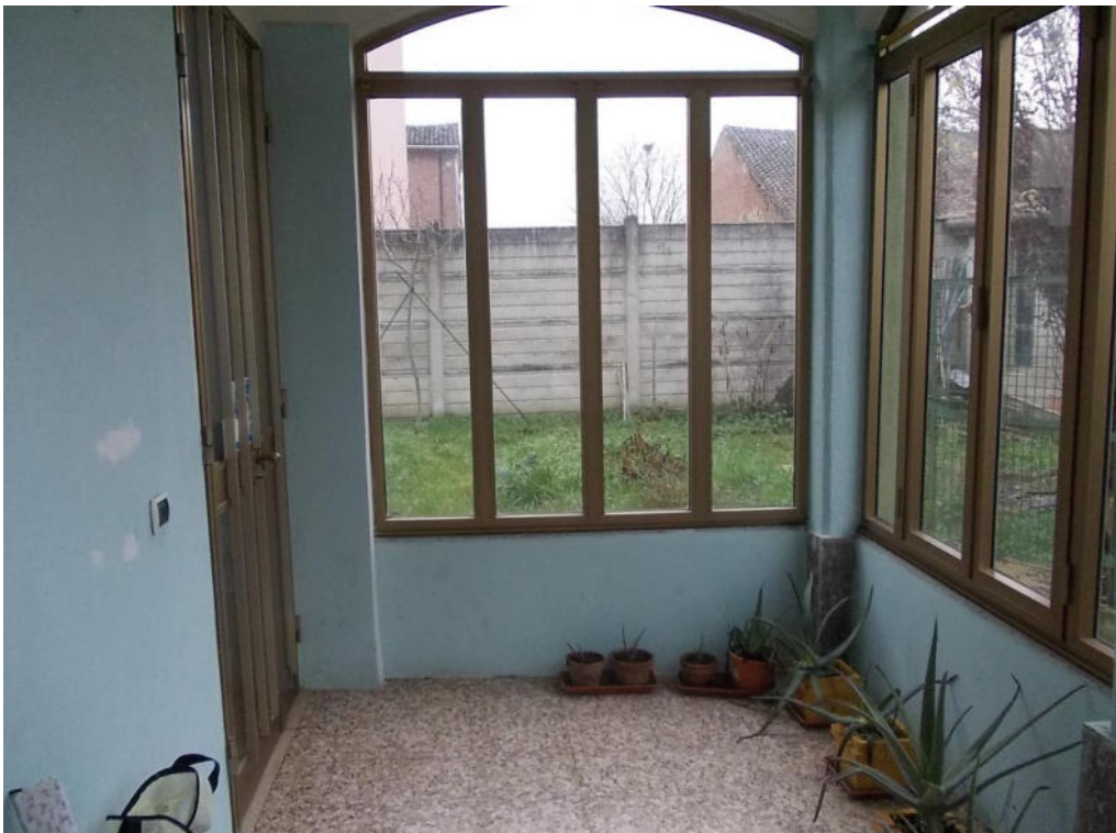
Foto 10 Loggia da regolarizzare (chiusura con vetrate) sub.1 p.t.
