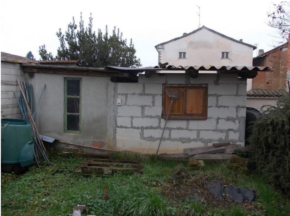
Foto 6 Prospetto est portico aperto abusivo – locale sgombero non accatastato N.C.T.
