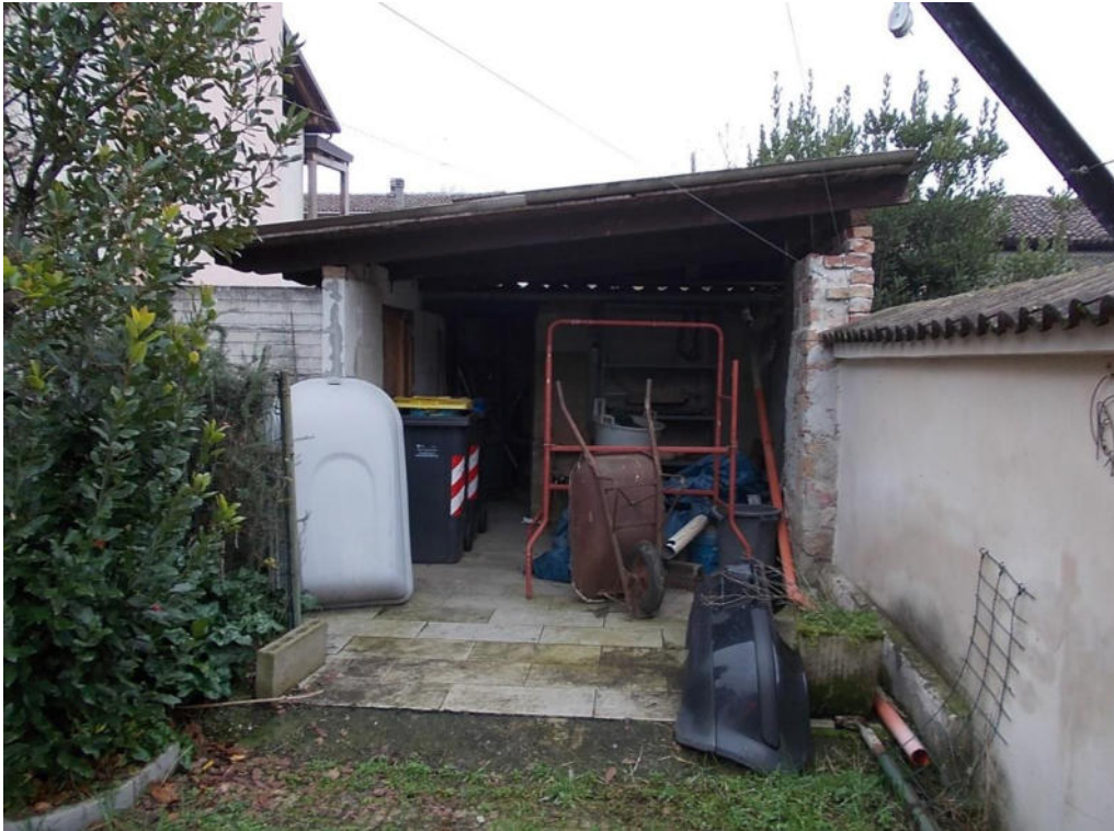
Foto 5 Prospetto nord portico aperto abusivo
