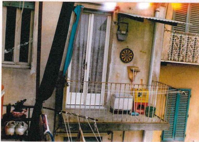
BALCONE APPARTAMENTO PIANO TERZO LATO MARE
