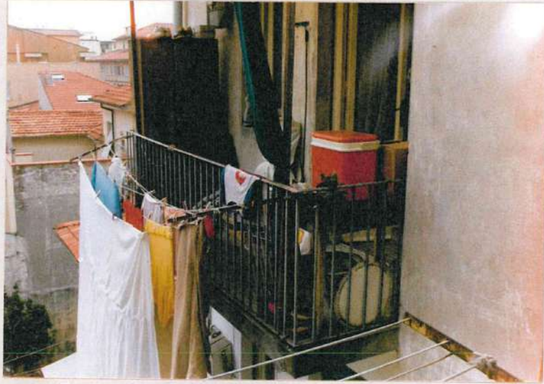
BALCONE APPARTAMENTO PIANO TERZO LATO MONTE
