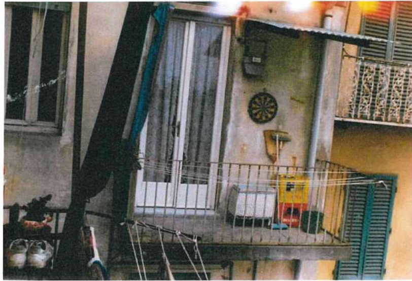
BALCONE APPARTAMENTO PIANO TERZO LATO MARE
