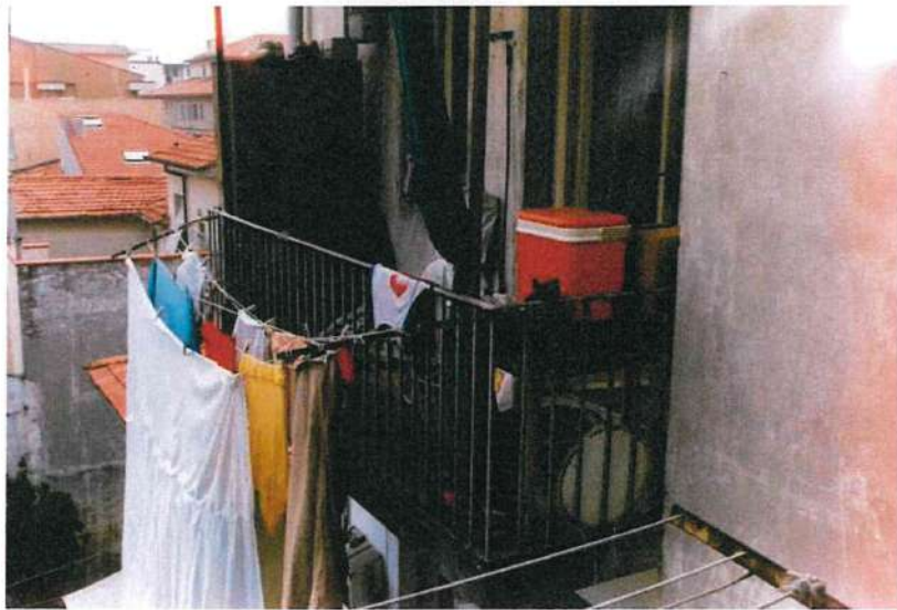
BALCONE APPARTAMENTO PIANO TERZO LATO MONTE
