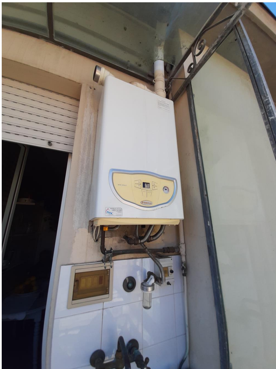
Foto n. 5 – Balcone coperto di proprietà posto sul retro - caldaia
