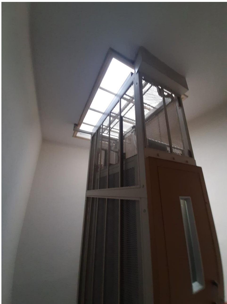
Foto n. 9 – Ascensore di arrivo al piano
