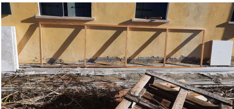
Figura 15 dettagli presenza umidità di risalita alla base delle pareti
