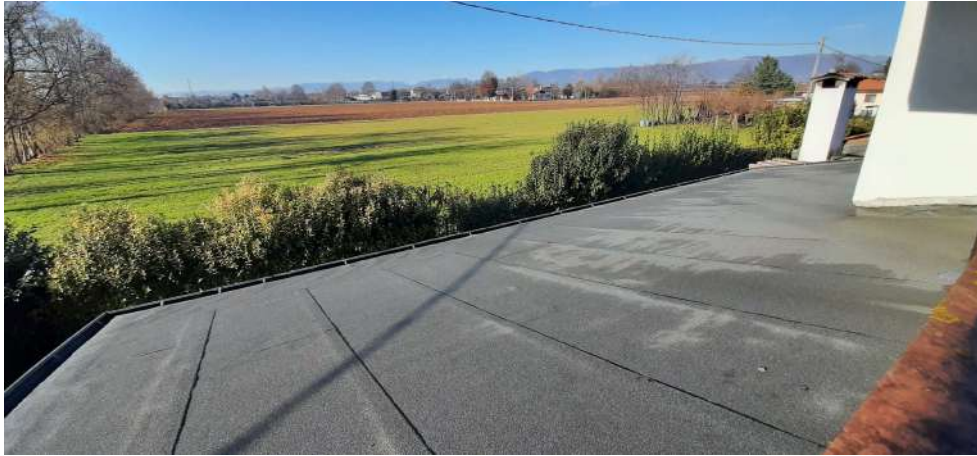
Figura 26 copertura portico con guaina priva di manto in coppi-tegole
