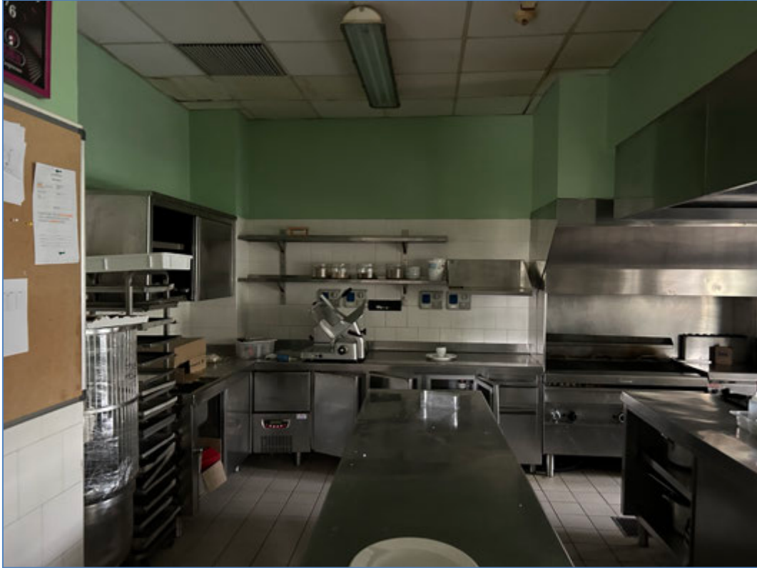
Interni dell'hotel - Cucina
