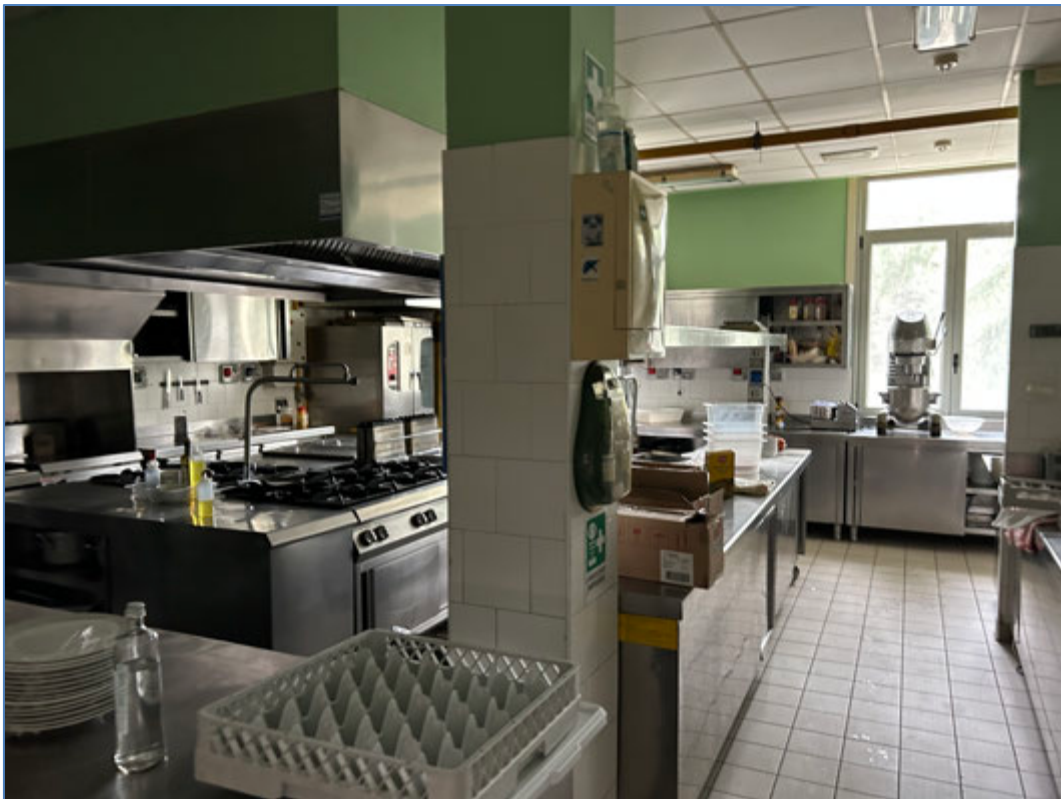
Interni dell'hotel - Cucina
