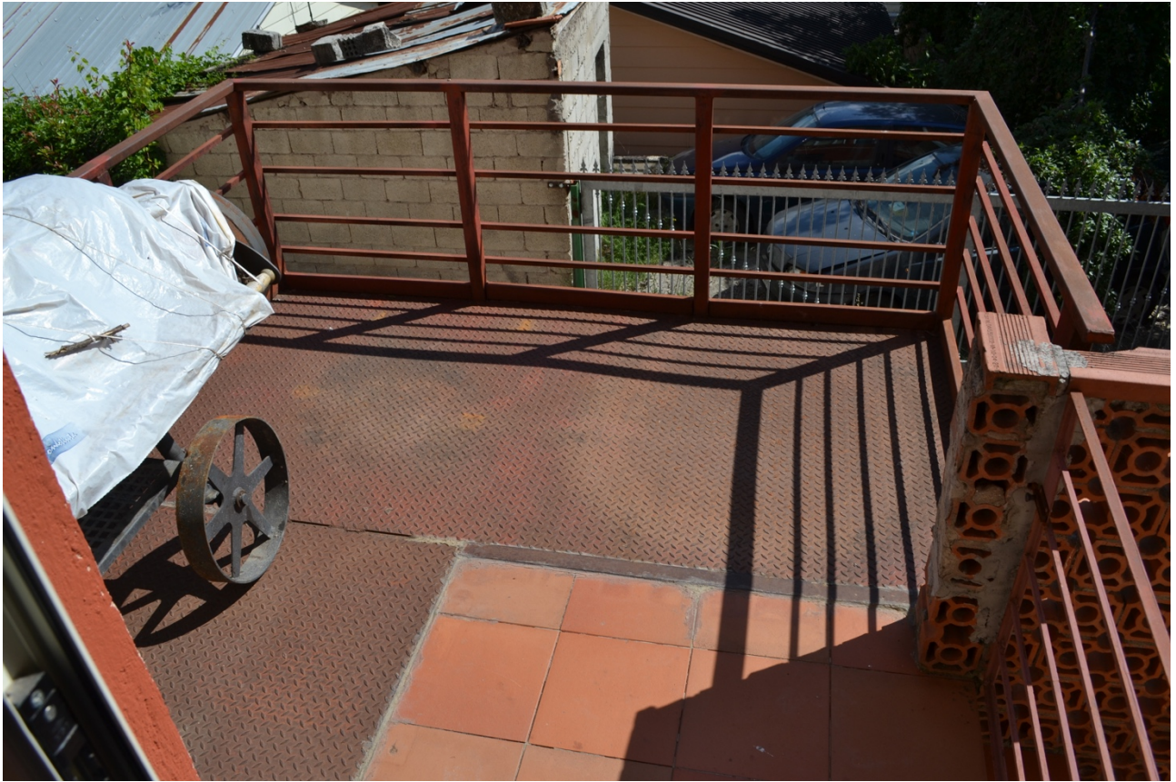
FOTO 7 - BALLATOIO ESTERNO VERSO CORTE DI DIETRO (PARTE IN METALLO DA SANARE)
