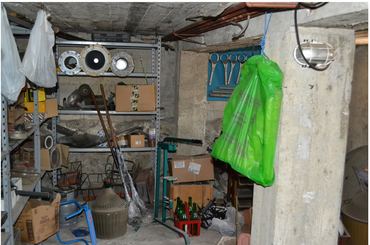
FOTO 6 - VANO TECNICO INTERRATO
