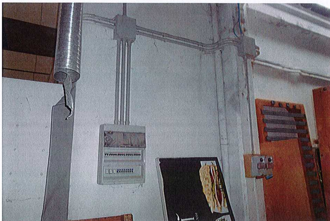
Quadro elettrico unità
