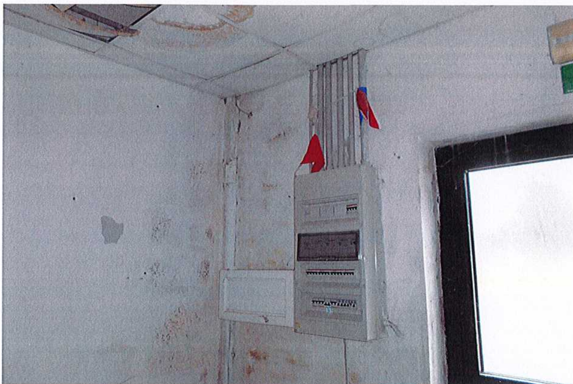
Quadro elettrico generale
