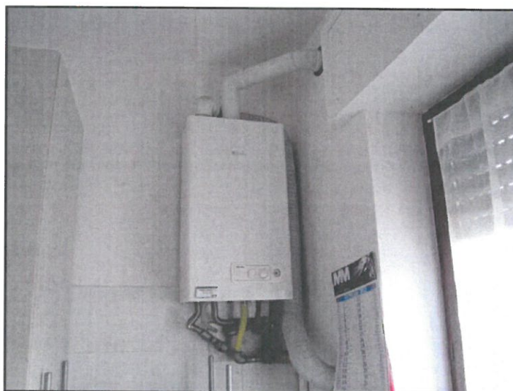
FOTO 15 U.I. MAPPALE 514 SUB. 3. ALTRA VISTA RIPRESA NELLA CUCINA VERSO LA CALDAIA.
