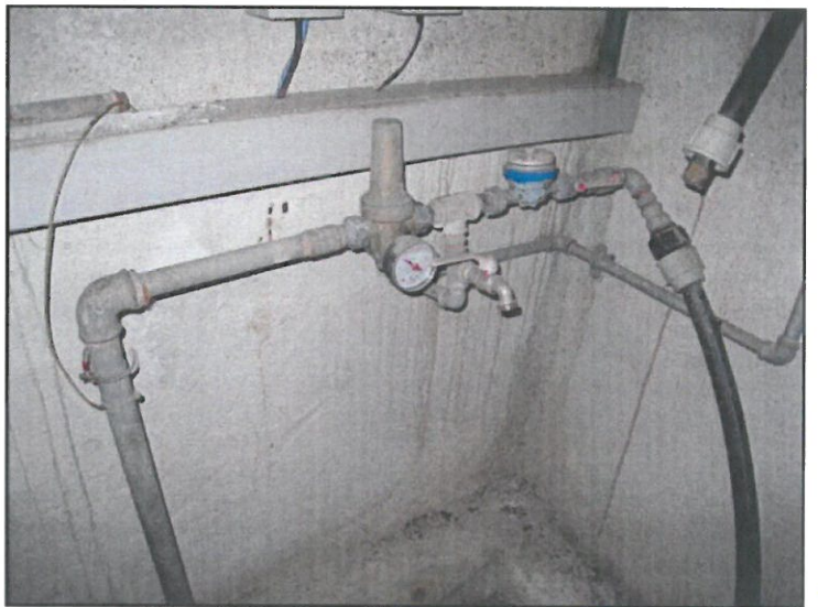
FOTO 42 VISTA CONTATORE COMUNE ACQUA POTABILE.
