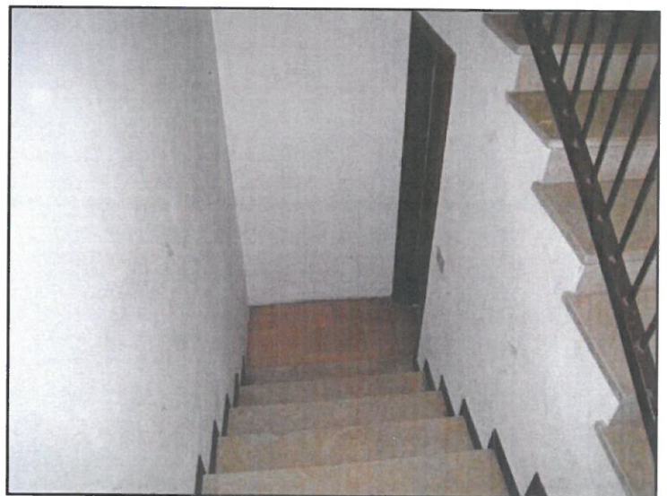
FOTO 39 VISTA RAMPA SCALA COMUNE DI ACCESSO LOCALE CONTATORI ELETTRICI E ACQUA POTABILE.
