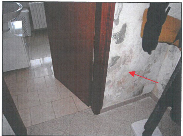
FOTO 32 U.I. MAPPALE 514 SUB. 3. VISTA PARTICOLARE DI INFILTRAZIONI TRA PARETE DISIMPEGNO NOTTE E BAGNO.
