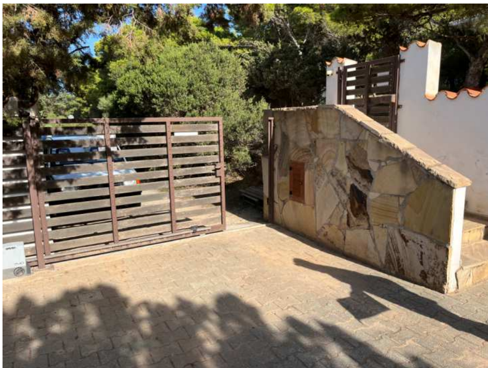
Cancelli di accesso e recinzione da riposizionare sul confine catastale.
