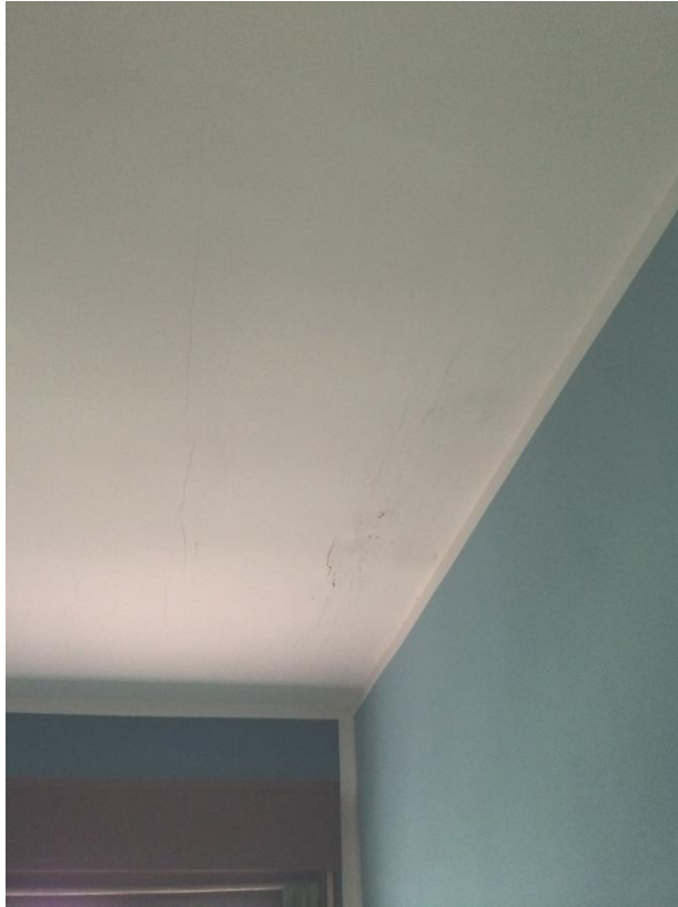
Lesioni sul soffitto della camera n. 1
