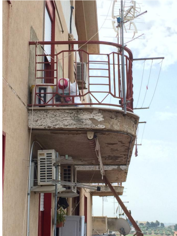
Carente stato di manutenzione del balcone dell'appartamento del terzo piano
