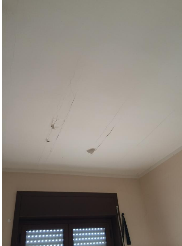
Lesioni sul soffitto della cucina
