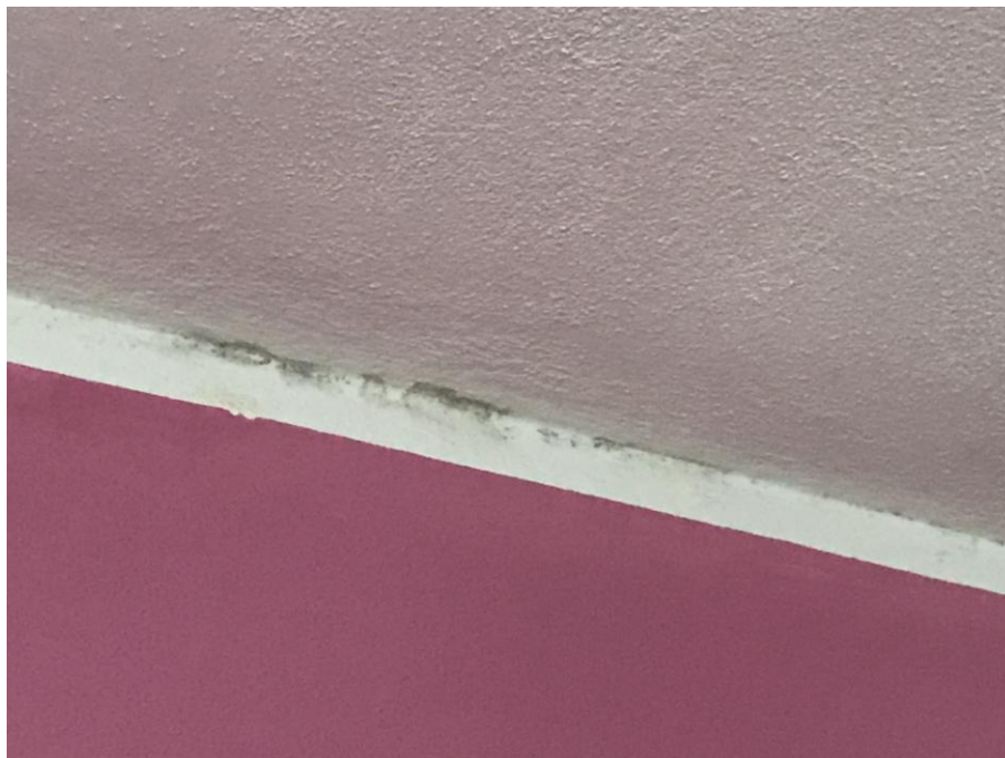
Imm. 20: Particolare dei danni dovuti alle infiltrazioni nel locale soggiorno
