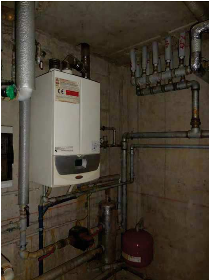
Foto 115 – piano interrato - centrale termica
