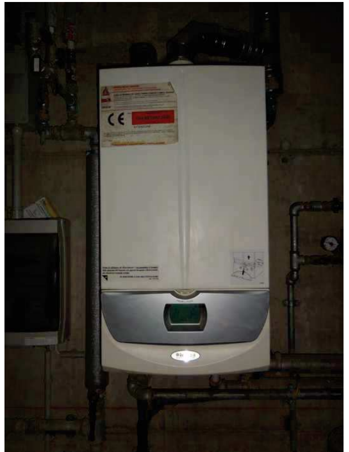
Foto 116 – piano interrato - centrale termica
