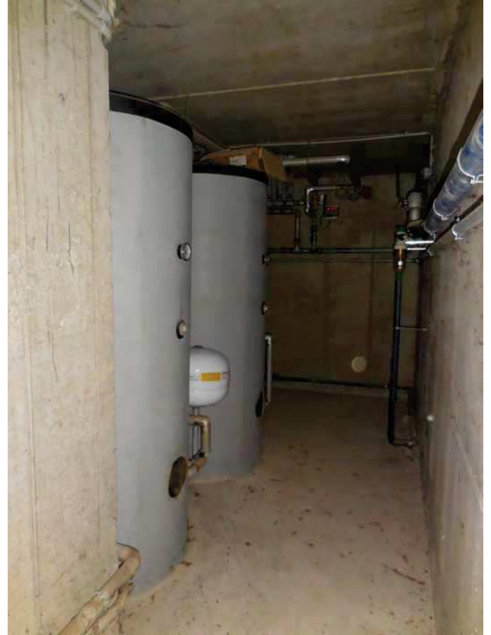
Foto 114 – piano interrato - centrale termica
