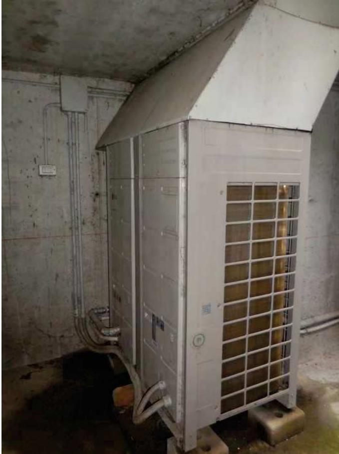
Foto 113 – piano interrato - centrale termica
