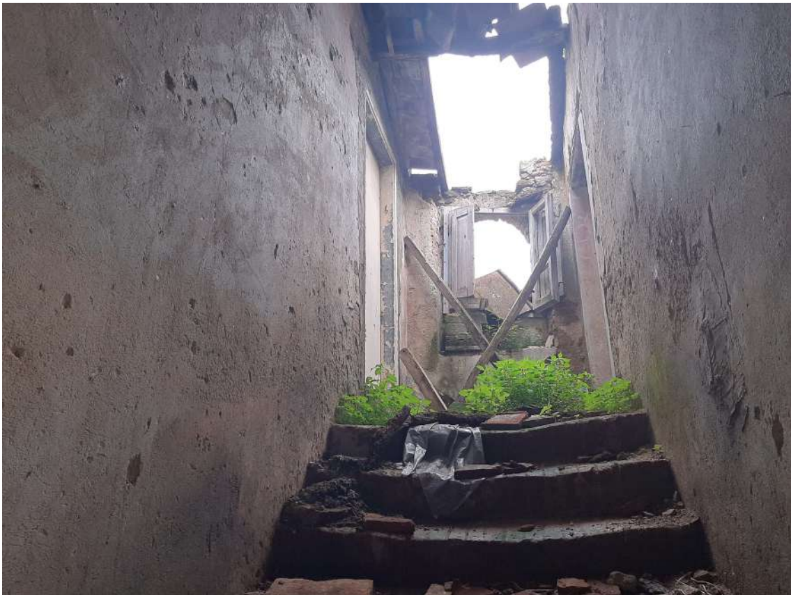
16 – Scala esterna a comune con copertura crollata.
