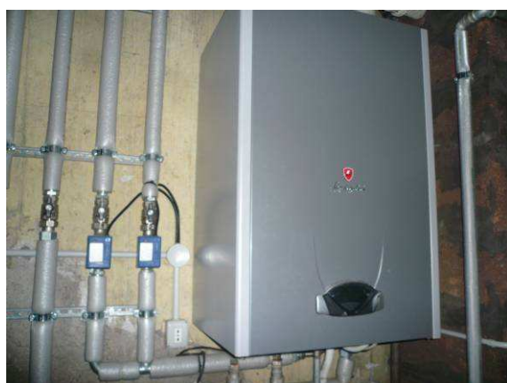
P. terra: caldaia
