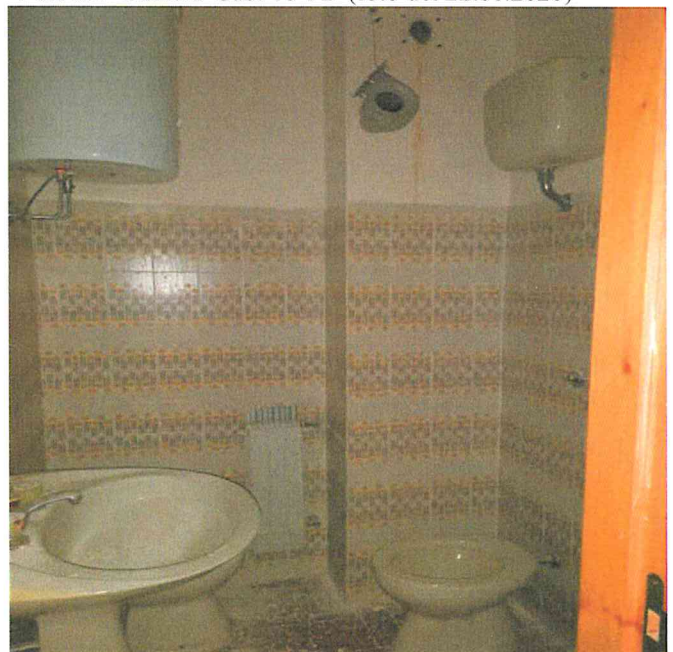
Foto n.6- Bagno Sub. 18-P2 (foto del 22.01.2020)
