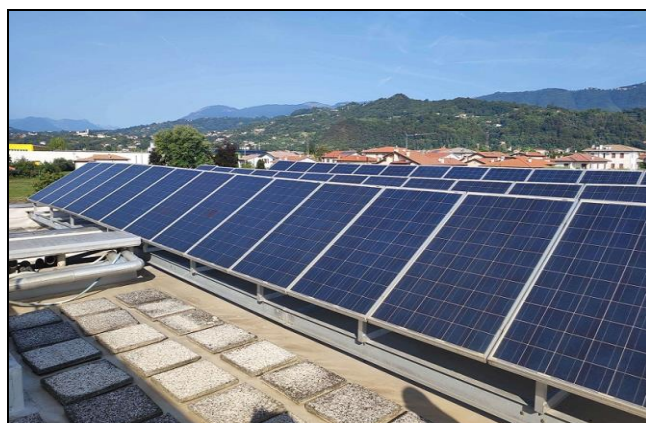
Fotovoltaico in copertura
