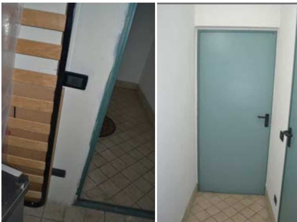
Figura 20 – Accesso al vano scale condominiale dall'autorimessa, attraverso porta REI
