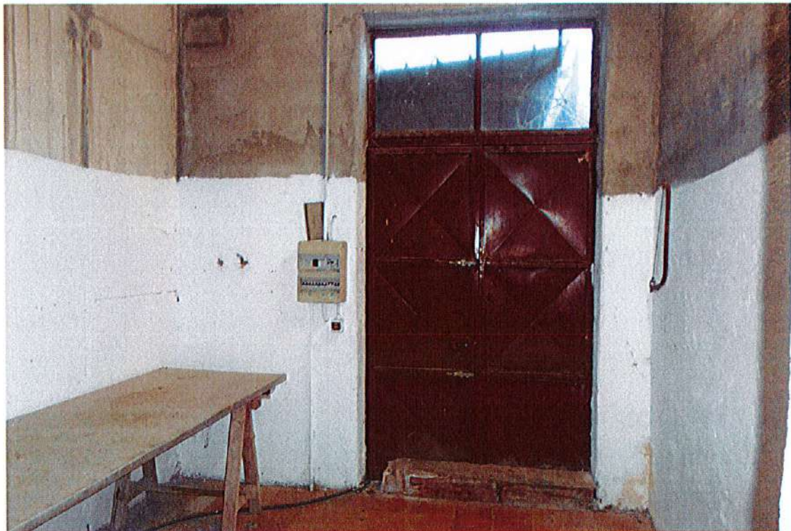
Porta accesso esterno C.T.
