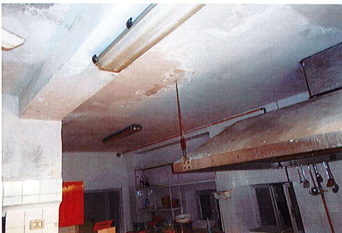
Infiltrazioni su soffitto prima cucina
