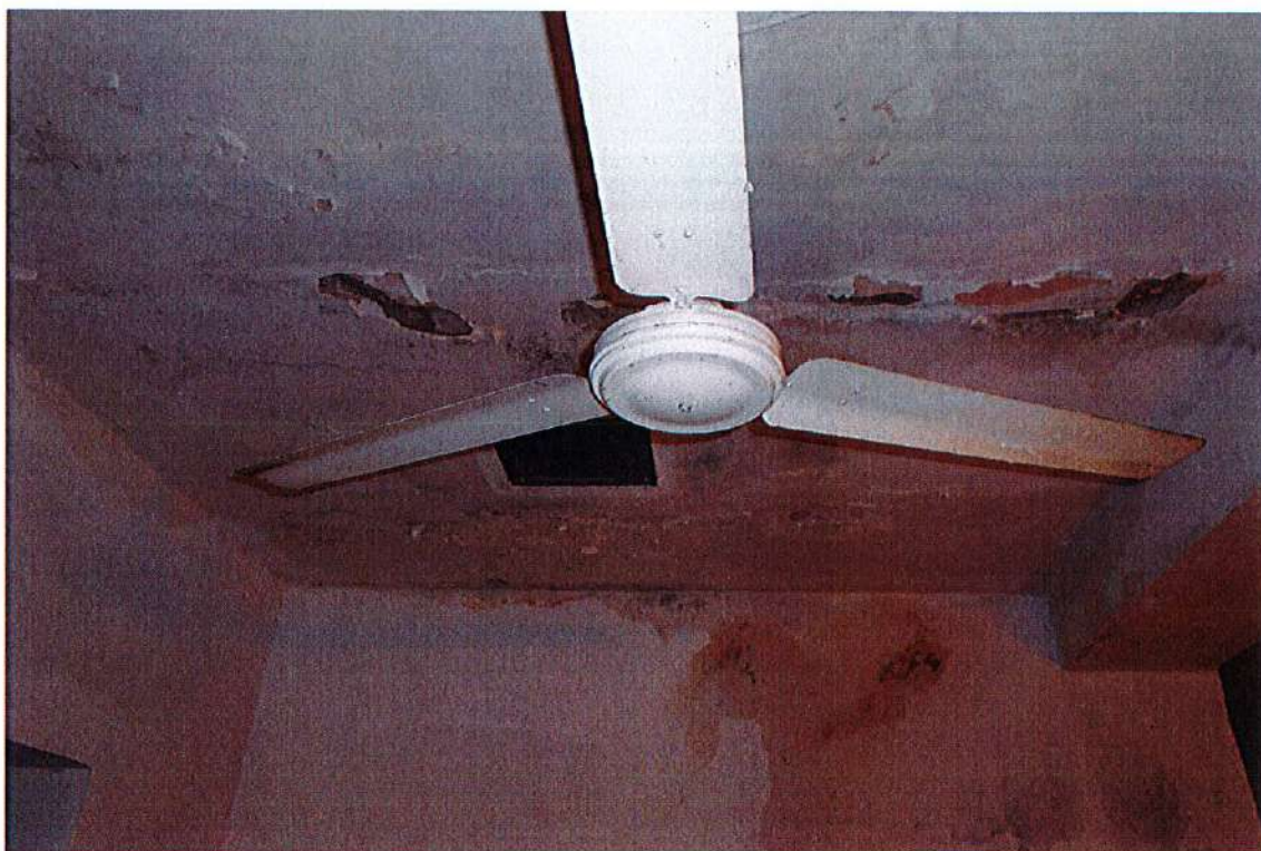
Infiltrazioni su soffitto prima cucina
