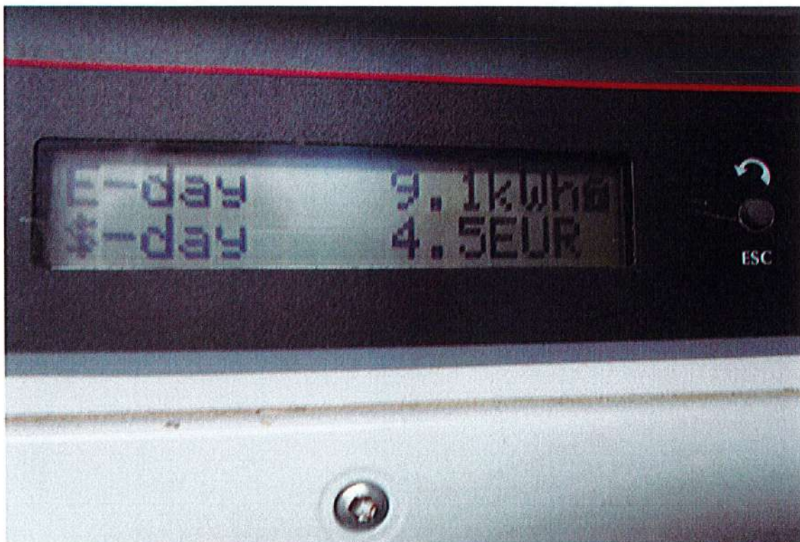
Particolare display inverter
