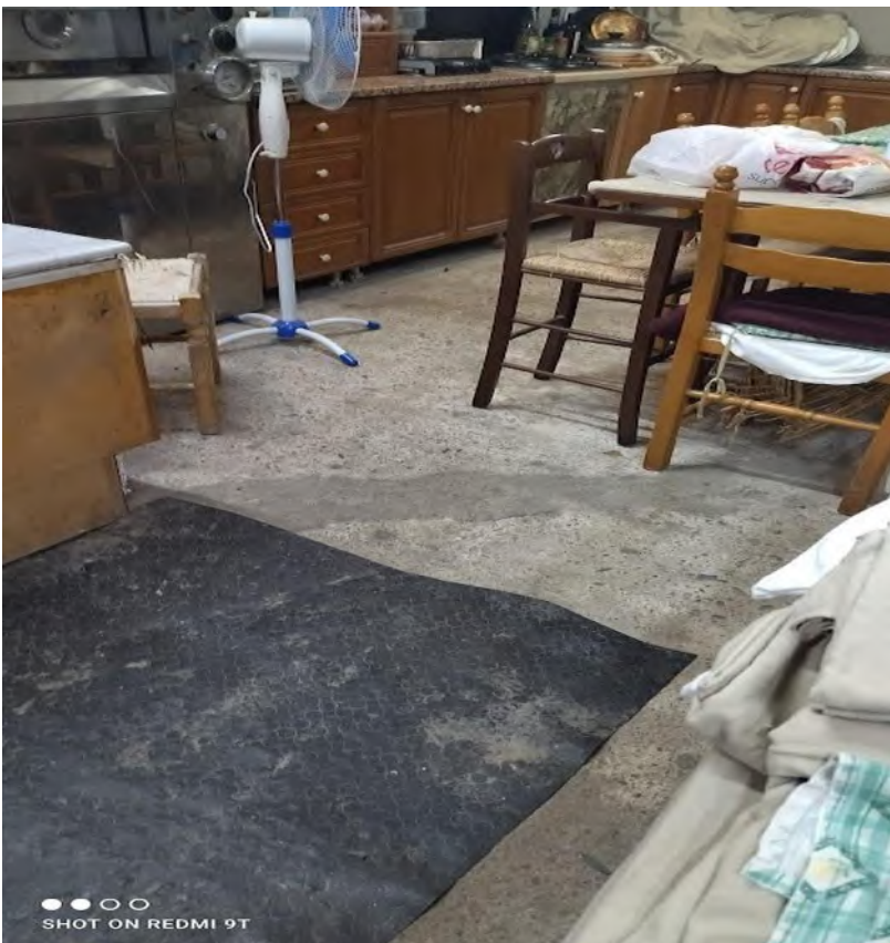
Particolare pavimento non rifinito in cls
