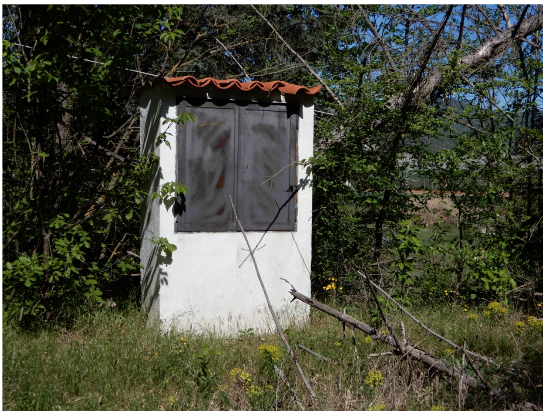
QUADRO CONTATORI ELETTRICI
