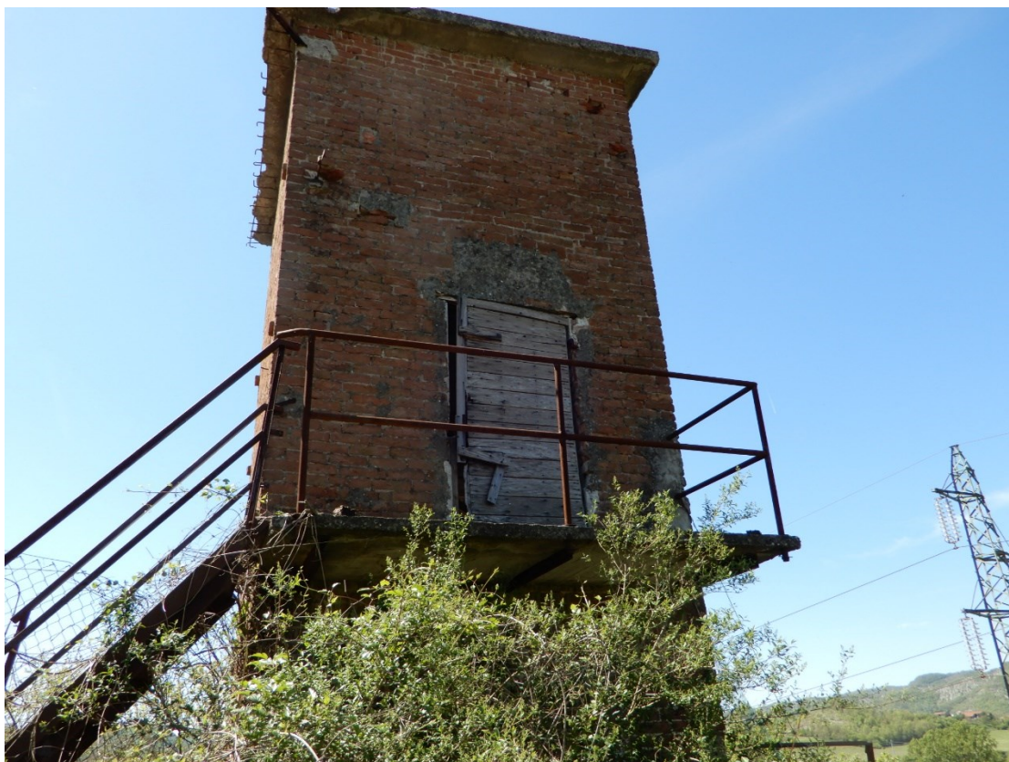
CABINA ELETTRICA DISMESSA
