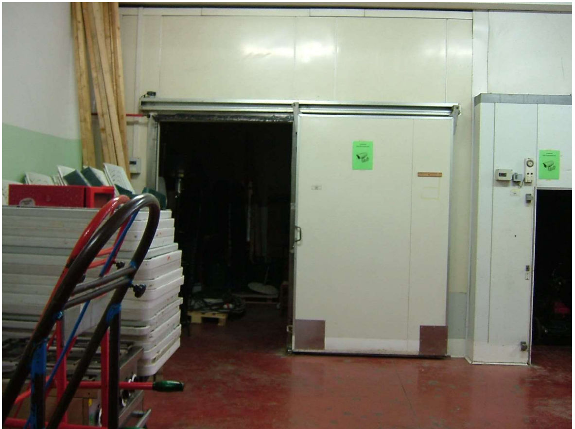
Foto 4 - cella frigorifera (sub 6)
