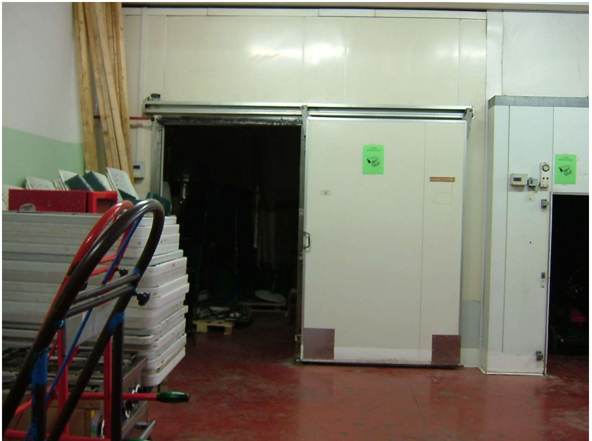
Foto 4 - cella frigorifera (sub 6)
