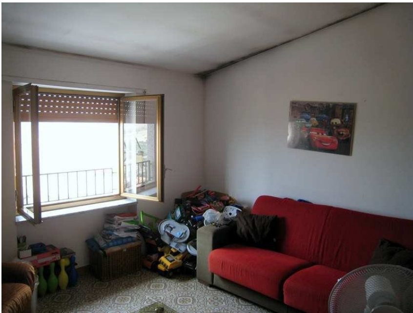
Foto n. 14-15-16. Il soggiorno. Anche sul tetto di questa stanza, se pure in forma minore, si è diffusa la muffa da condensa. Pure negli angoli vi sono colonie.
