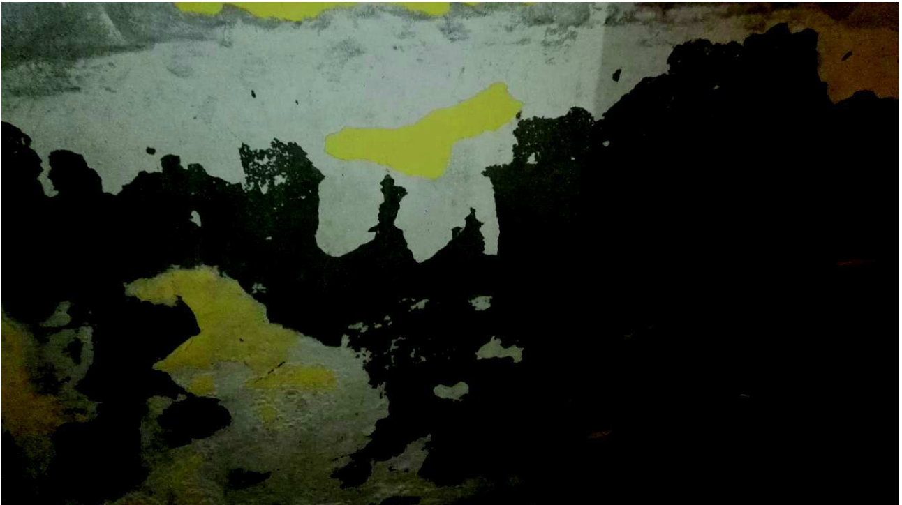
Intonaco ammalorato nell'interrato
