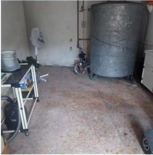
Cisterna di acciaio zincato contenente l'acqua di riserva per alimentare l'appartamento attraverso la pompa elettrica "autoclave"
