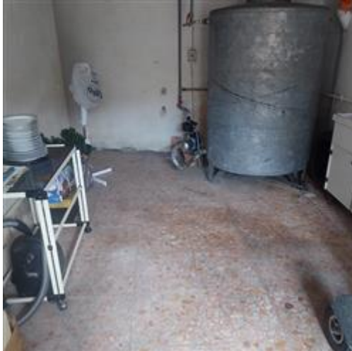
foto della Cisterna di accumulo acqua di riserva con pompa autoclave
